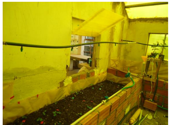
Nebulizadores instalados sobre las camas de propagación
