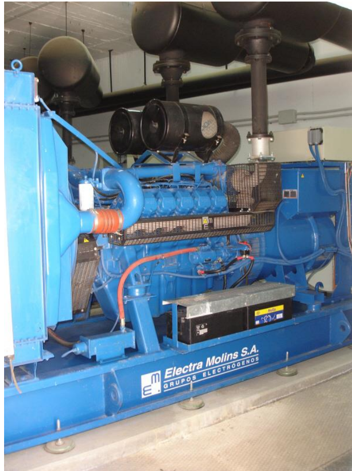
Fig. 2.4. Grupo eléctrico (Fuente: Internet)
