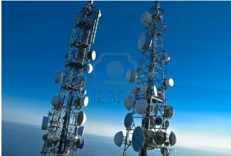
Figura 11. Antenas de radio enlace (Fuente: Internet).
