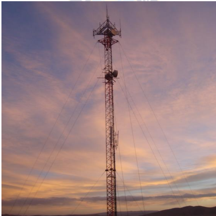
Figura 7. Torre arriostrada (Fuente: Propia).
