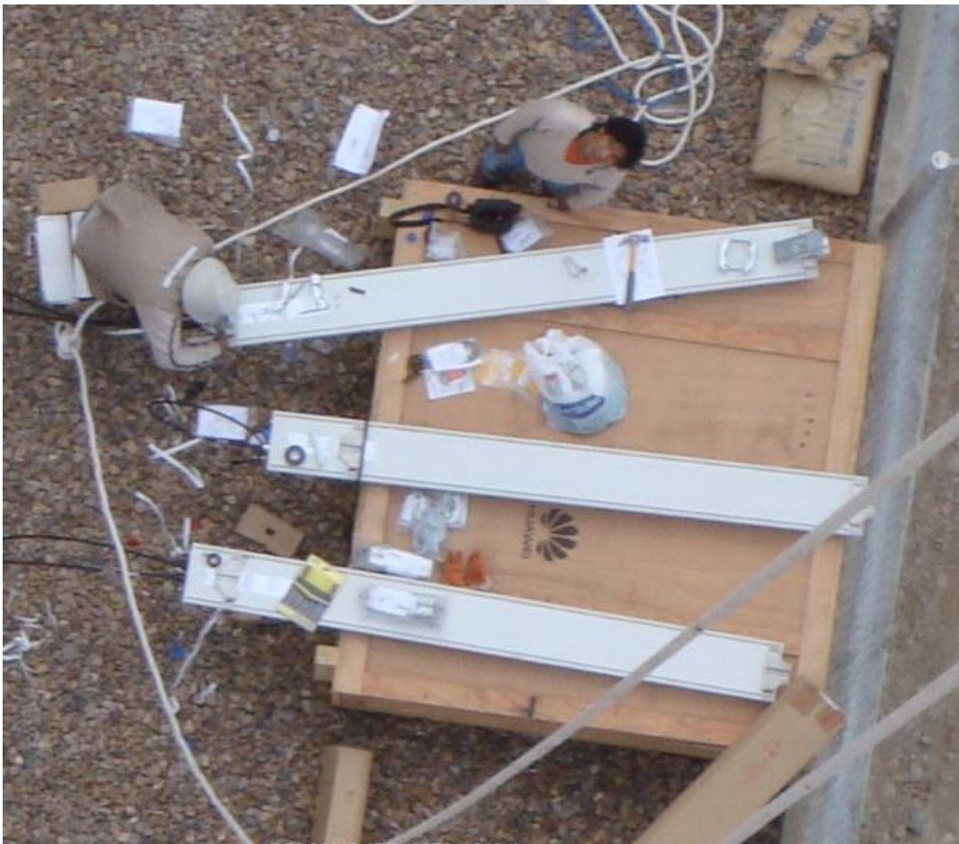
Figura 35. Ensamblado de antenas sectoriales con sus abrazaderas y sus respectivos jumpers (Fuente: Propia).
