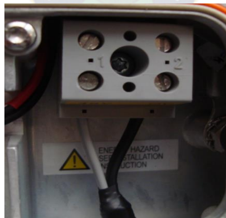
Figura 51. Conexión de alimentación correcta, cable negro a 0Vdc y el cable plomo a -48Vdc (Fuente: Propia)
