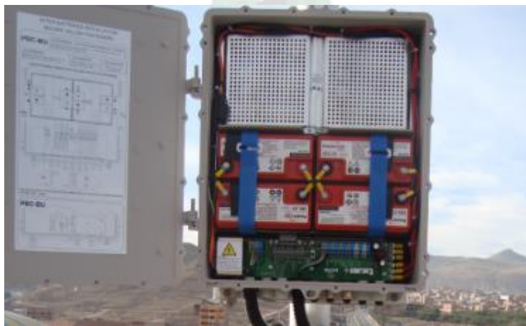
Figura 18. Fotografía de la PBC-MU con su banco de 4 baterías (Fuente: Propia).
