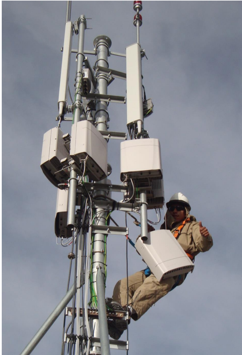
Figura 25. RRU'S instaladas en un Monoposte la configuración de la radio base en la fotografía es de 4+4+4 debido a que lleva dos RRU'S en cada sector y dos MU'S que controlan los sectores (Fuente: Propia)
