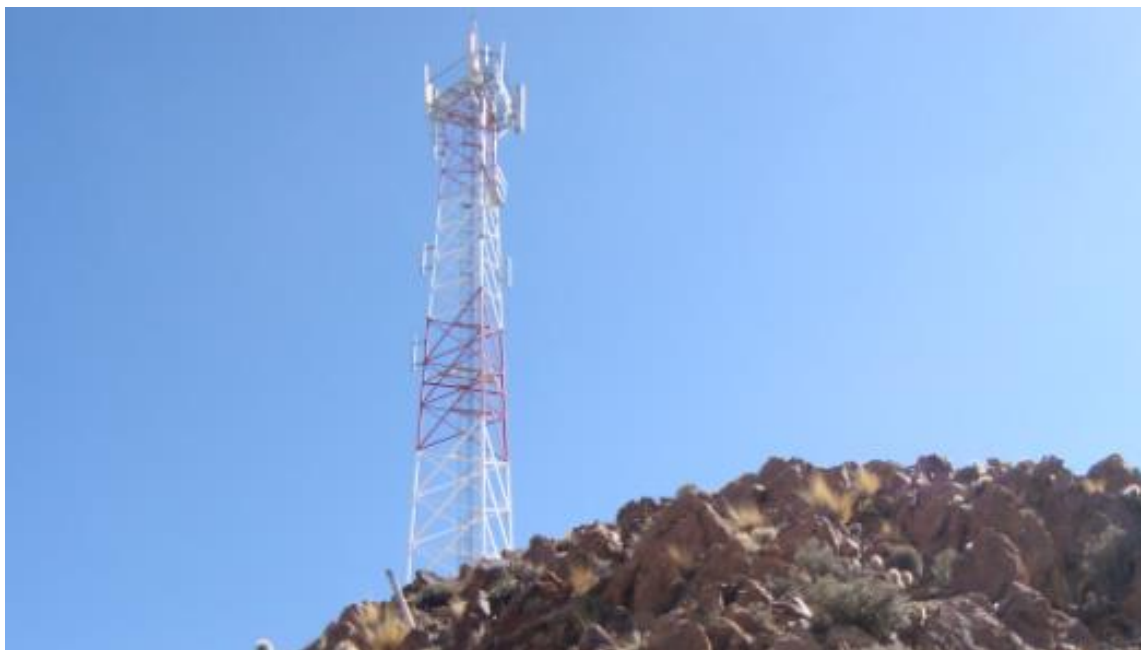
Figura 52. BTS Ericsson 2111 concluida (Fuente Propia)
