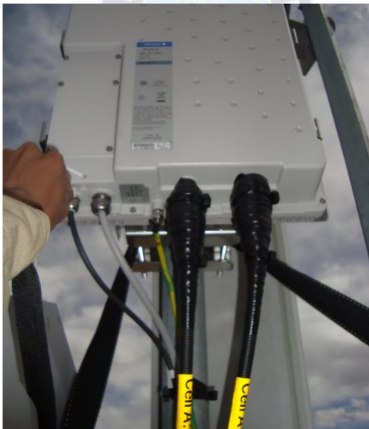
Figura 42. Conexiones en la RRU (Fuente: Propia).
