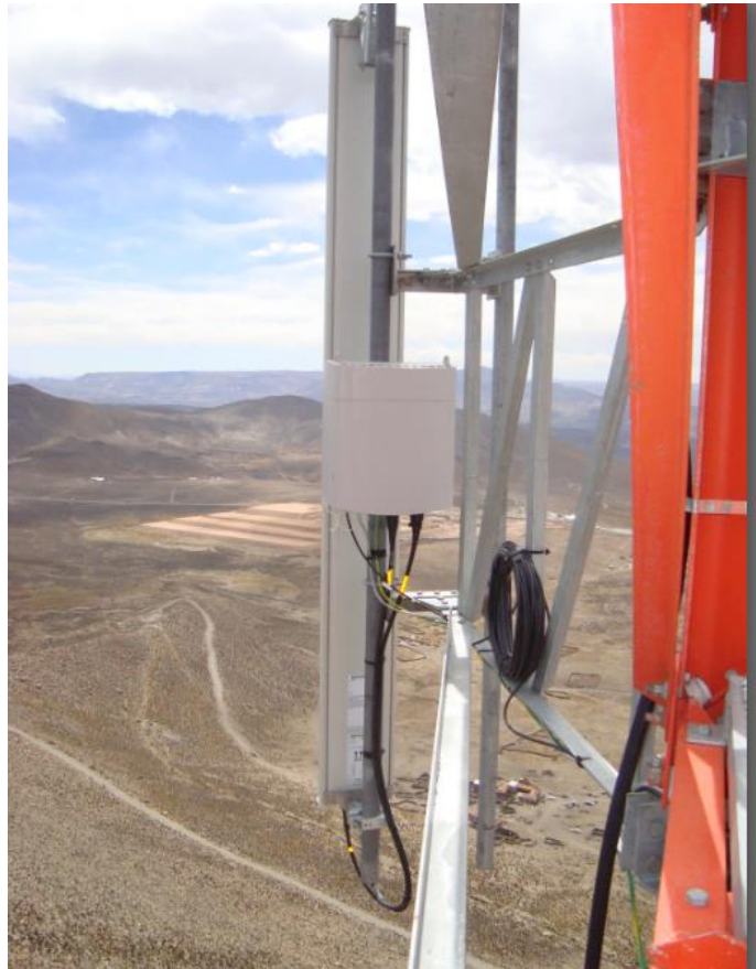
Figura 43. Antena y RRU correctamente instaladas (Fuente: Propia).
