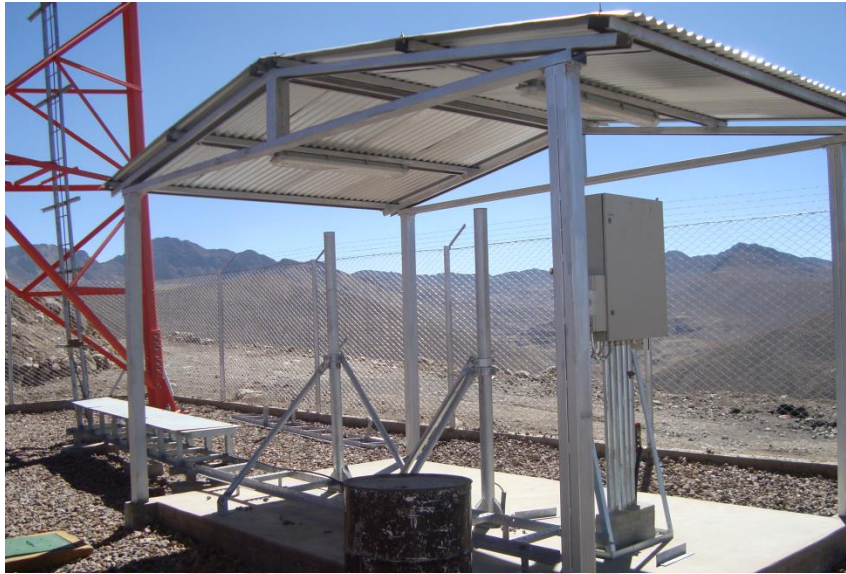
Figura 44. Soportes para instalar los equipos outdoor (Fuente: Propia).
