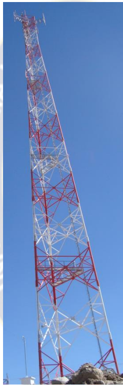
Figura 6. Torre autosoportada (Fuente: Propia).
