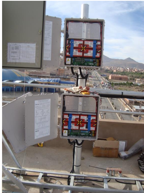
Figura 14. banco de baterías Ericsson 2111 (Fuente: Propia)
