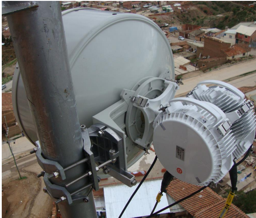
Figura 32. Antena de Radio Enlace Huawei OPTIX RTN 620 (Fuente: Propia).
