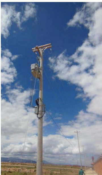
TRANSFORMADOR PARA MEDIA TENSIÓN Fuente: Empresa de Electrificación de Oruro
