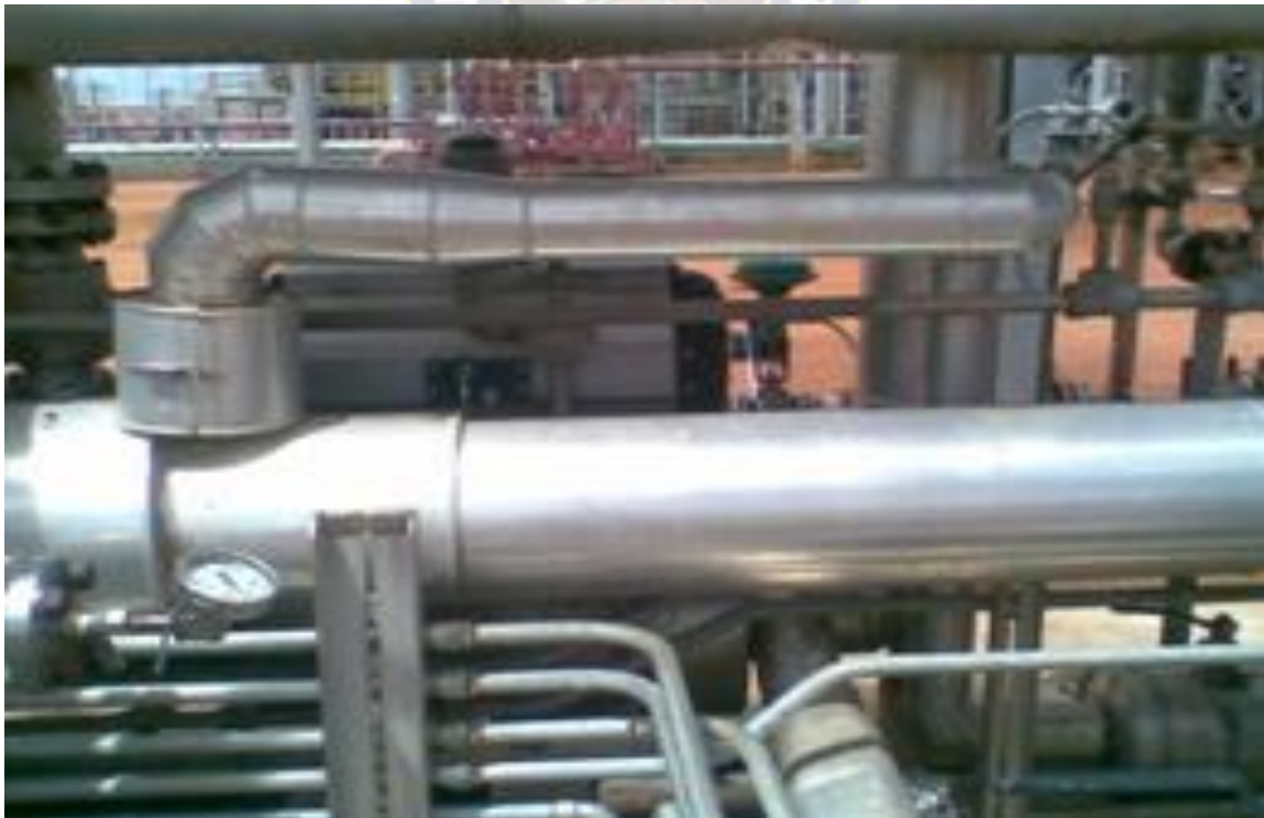
INTERCAMBIADOR DE CALOR
