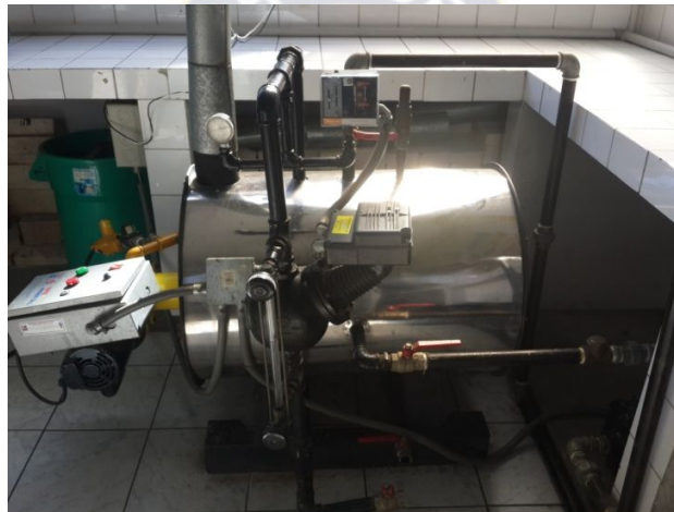
Foto 3. Generador de vapor, de la Carrera de QMC-IND
