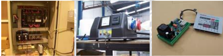
Figura #14 Controladores de grupos electrónicos.
