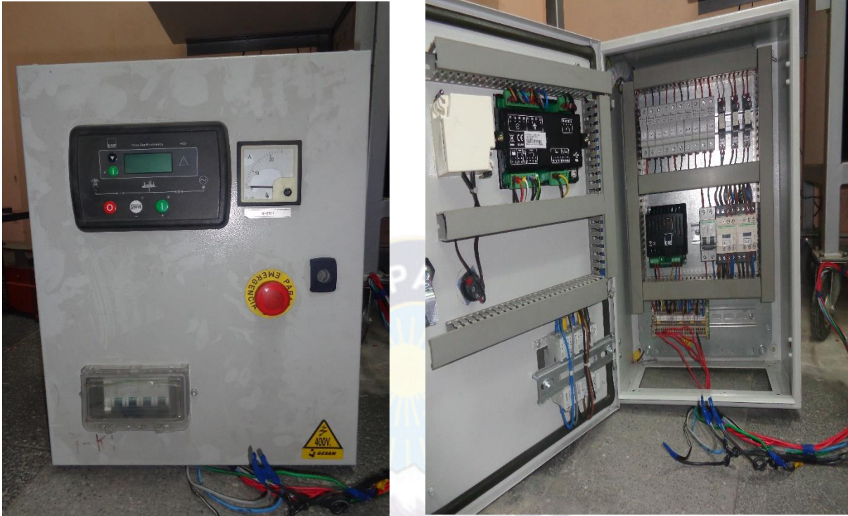
Figura #2 foto parte externa e interna del tablero de control del grupo electrógeno.
