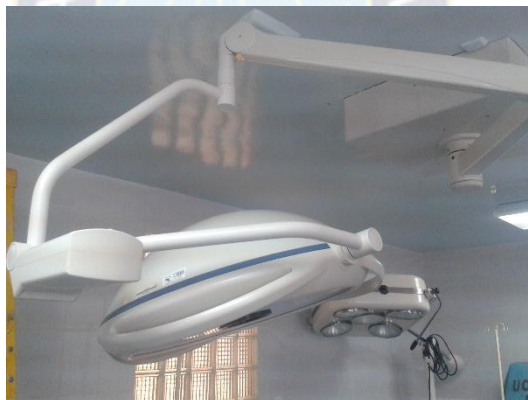
Lámpara de quirófano Figura N° 3.18 Fuente: Propia
