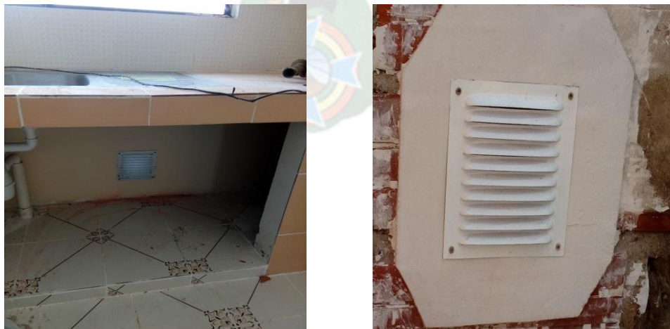
FOTOGRAFIA 1. Rejilla de entrada de aire.
