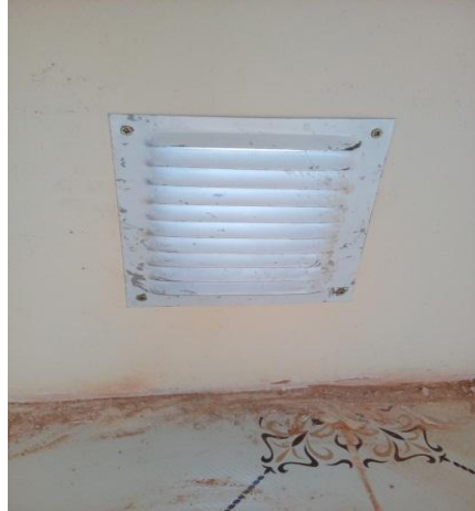
FOTOGRAFIA 1. Rejilla entrada de aire pasillo
