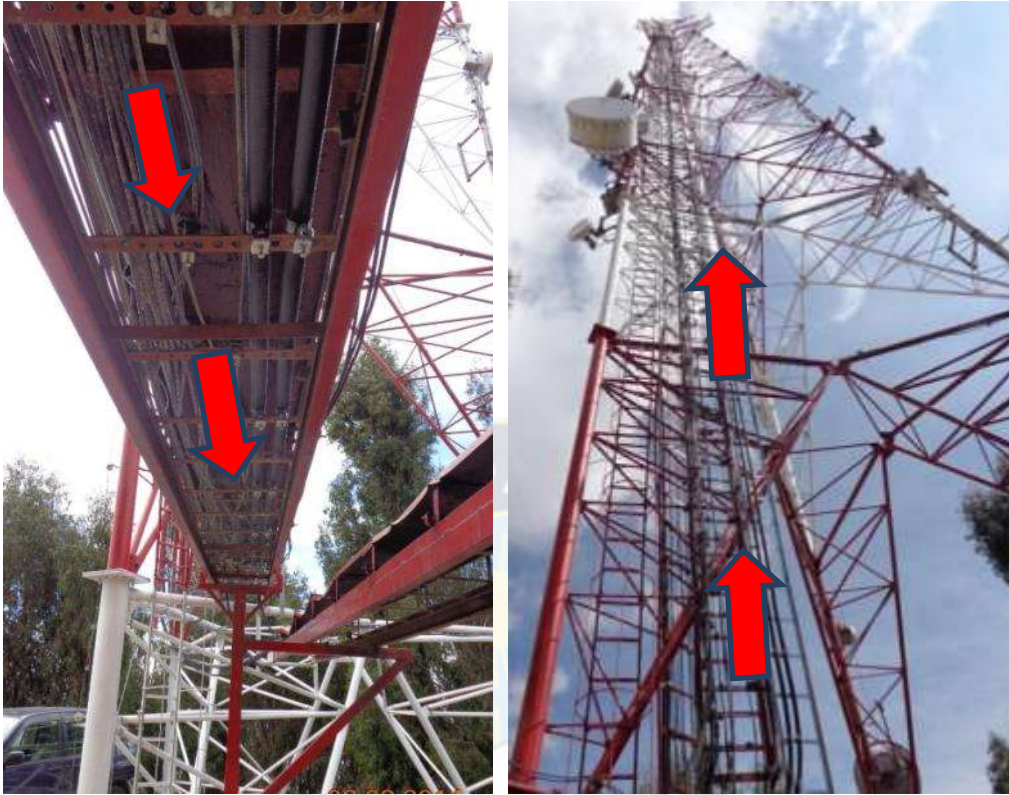
Figura 5.7: Recorrido del cable IF en escalerilla Horizontal y vertical.
