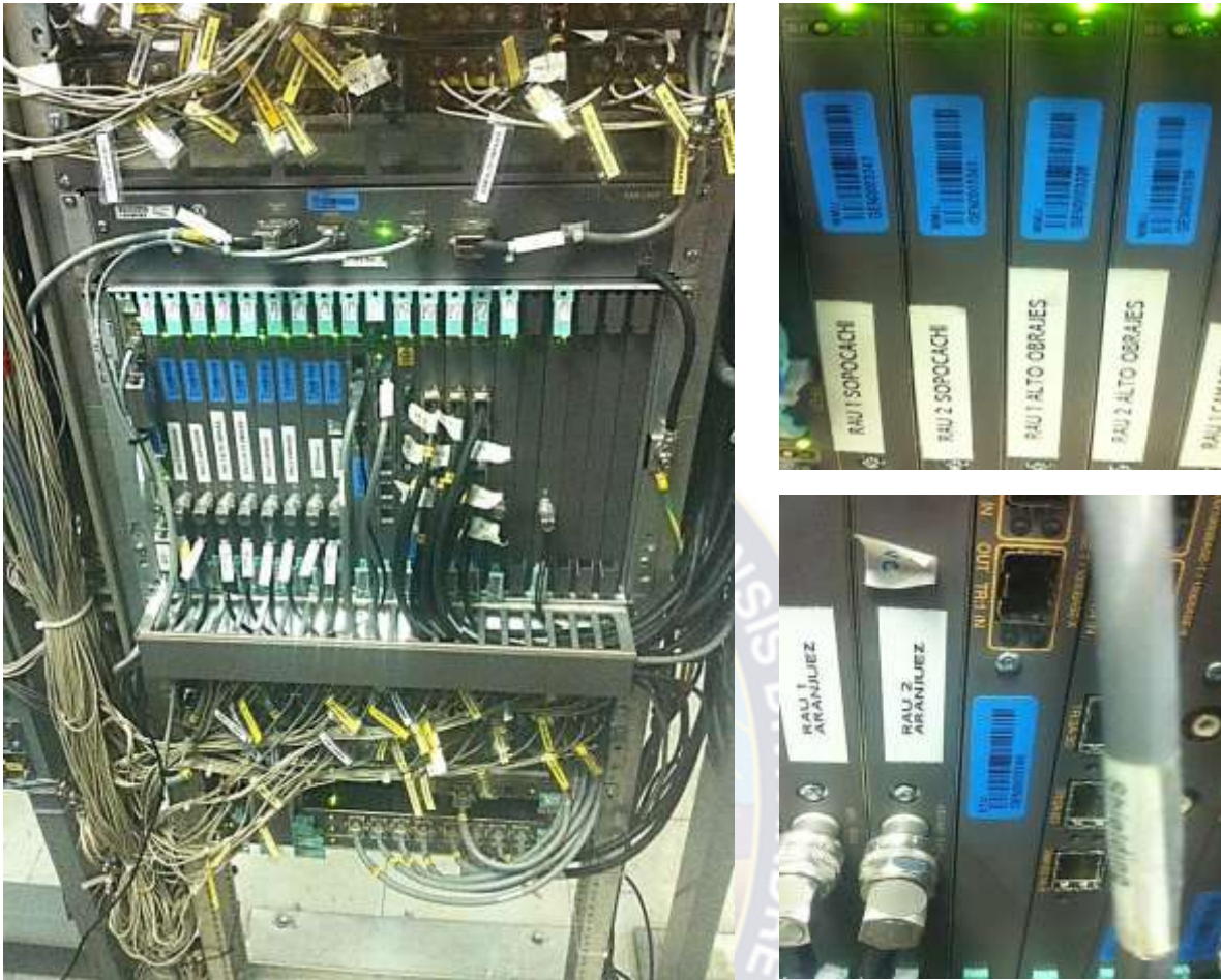
Figura 5.13: Rack con TN
