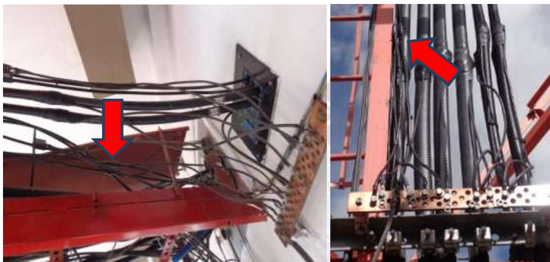
Figura 5.5: Kit de tierra en cable FI y conexión a barra de aterramiento.
