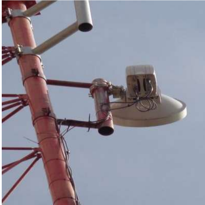
Figura 5.3: Antena y radios del enlace ALPACOMA- SOPOCACHI
