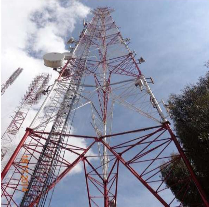
Figura 5.1: Panorámica de la torre ALPACOMA
