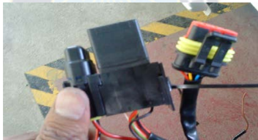
Figura 39.- Fusible y relé que protege la centralita del GNC
