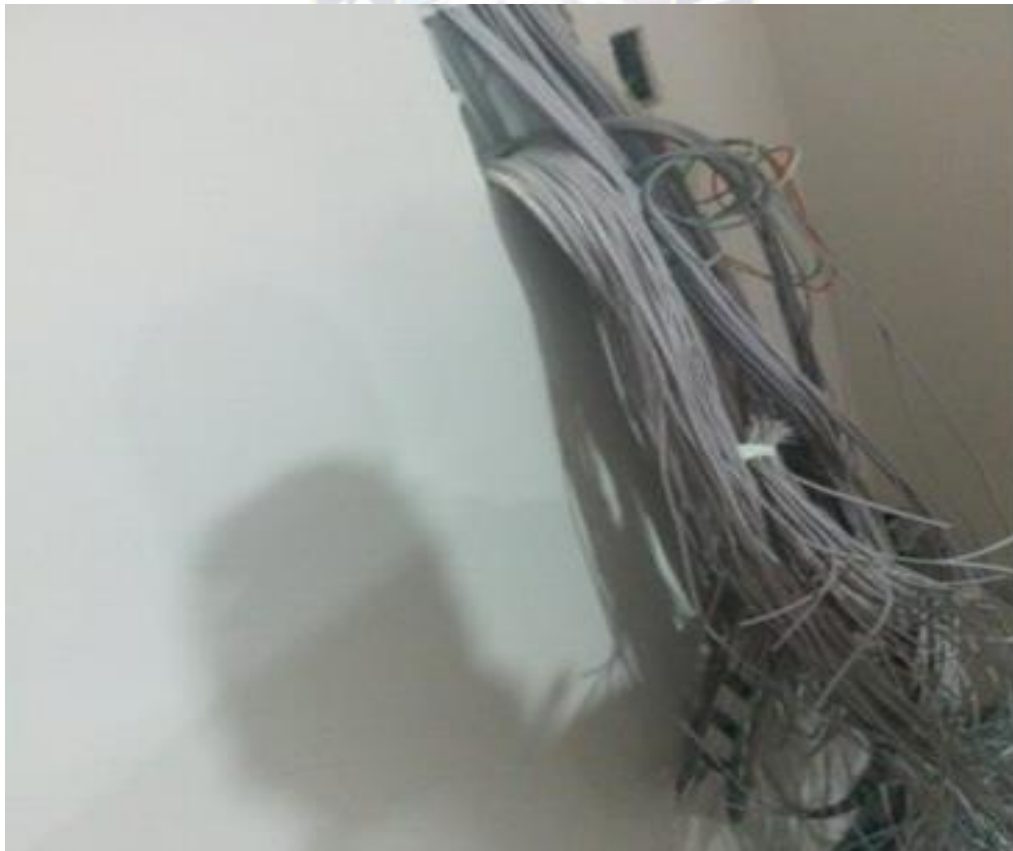
Figura N°4.6 Esquema de llegada de cables para la central de alarma Fuente: fotografía, llegada de cables al ambiente del panel, tomada por el autor
