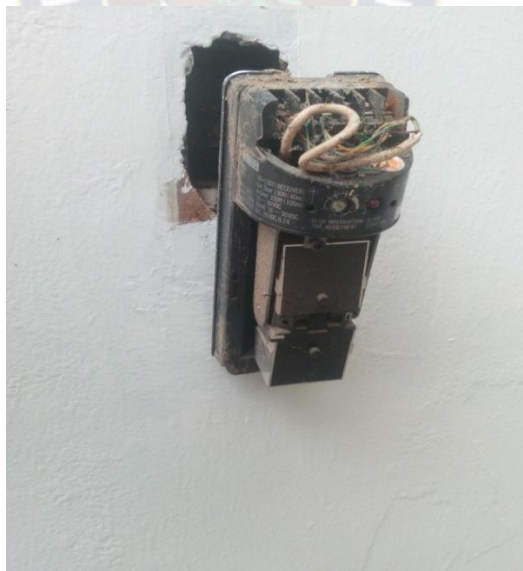
Figura N°5.3 Sensor Tx barrera infrarroja deteriorado y oxidado
