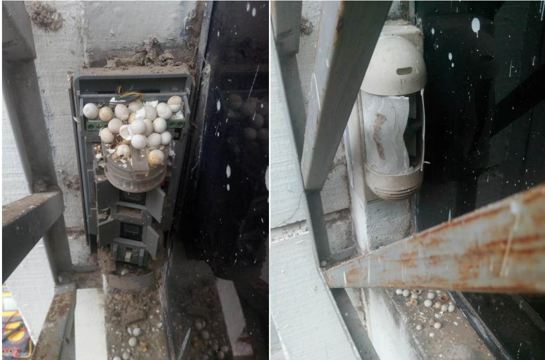
Figura N°5.2 Sensor Vx instalado en una azotea sin funcionamiento a causa de oxidación y lagartijas en el lugar
