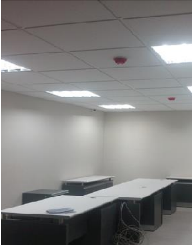
Figura N°4.23 Oficina con dos detectores de humo
