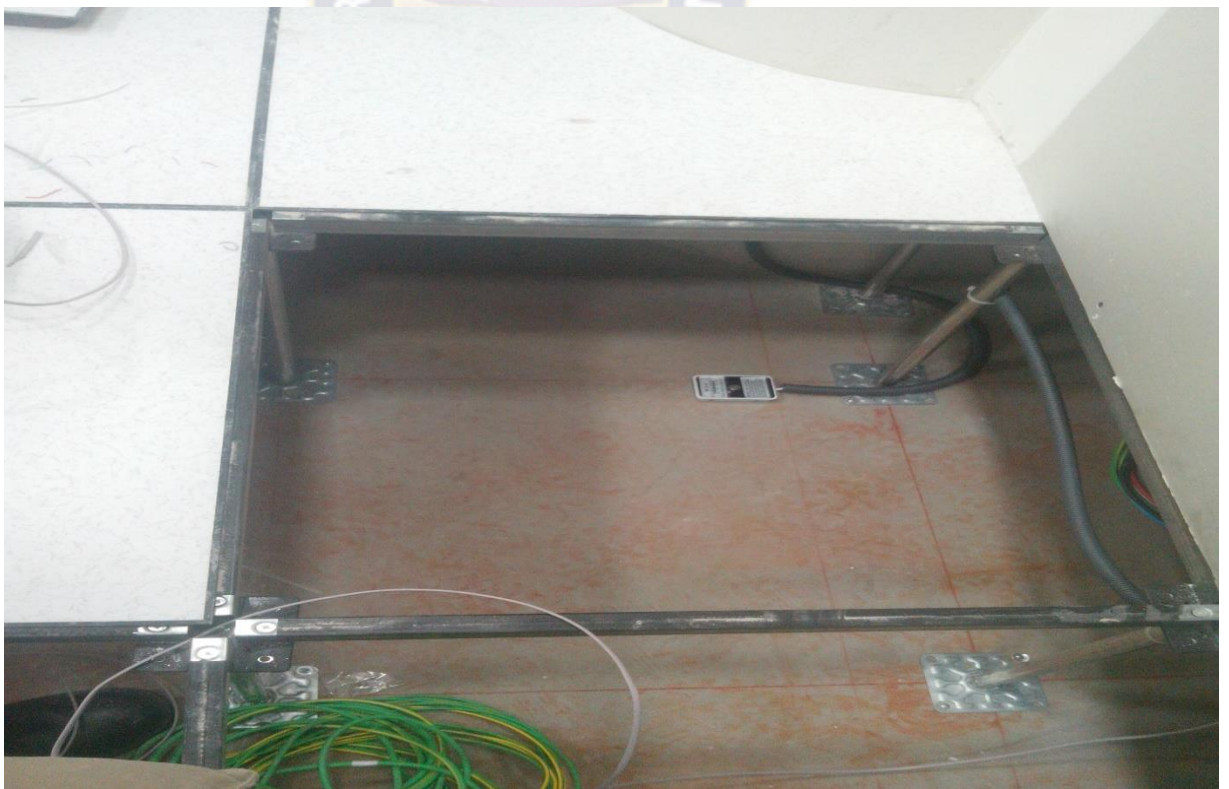
Figura N°4.28 Sensor de Agua instalado debajo del piso técnico Fuente: fotografía tomada por el auto
