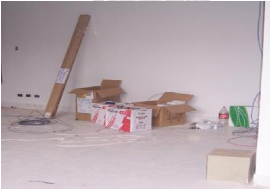
Figura N°4.39 Cajas de Cables UTP.cat6 y cable canales Fuente : fotografía tomada por el autor, en una nueva instalacion
