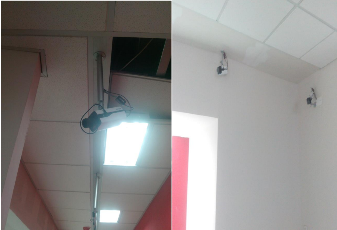
Figura N°4.41 Cámaras instaladas en diferentes ambientes con y sin soporte Fuente : fotografía tomada por el autor
