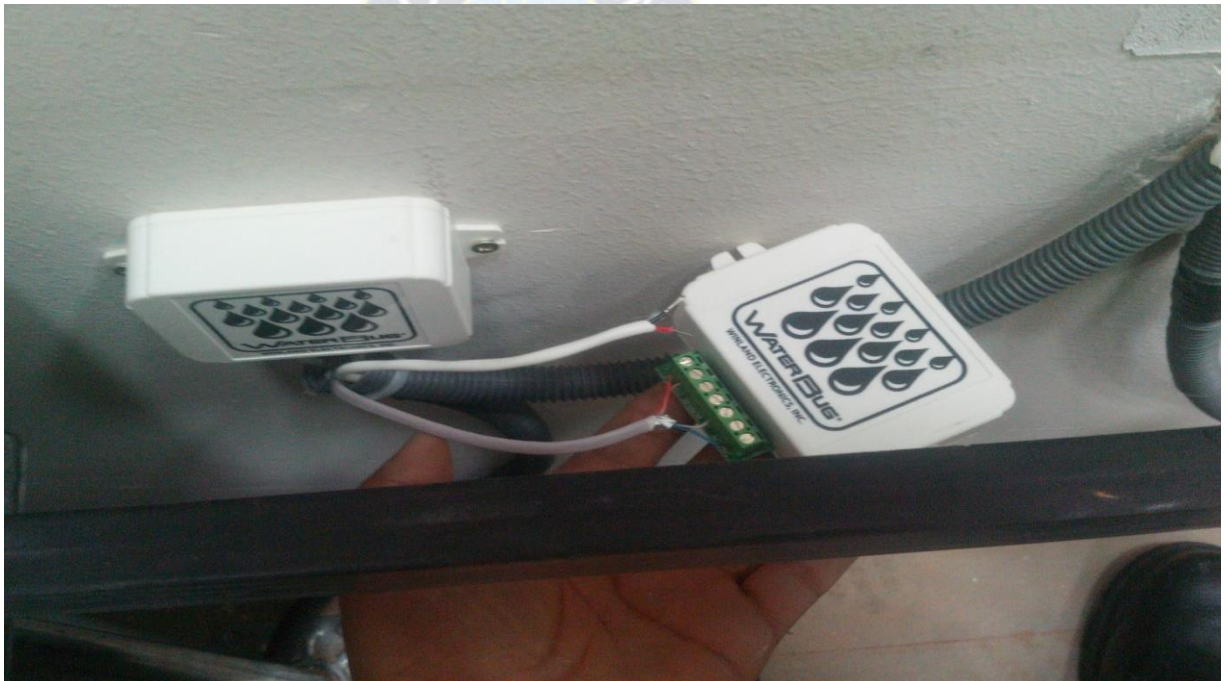
Figura N°4.26 Dos módulos de Sensores de Agua
