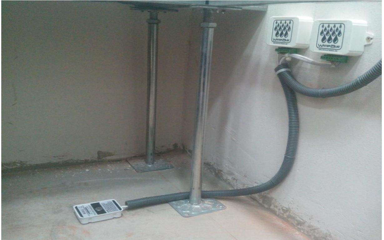
Figura N°4.27 Sensor de Agua en funcionamiento Fuente: fotografía tomada por el autor
