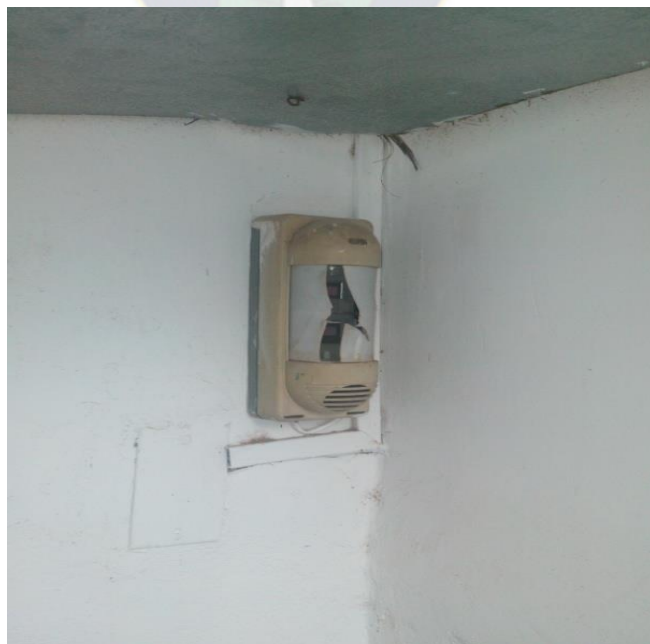
Figura N°5.1 Sensor VX con barrera infrarroja regulable deteriorado
