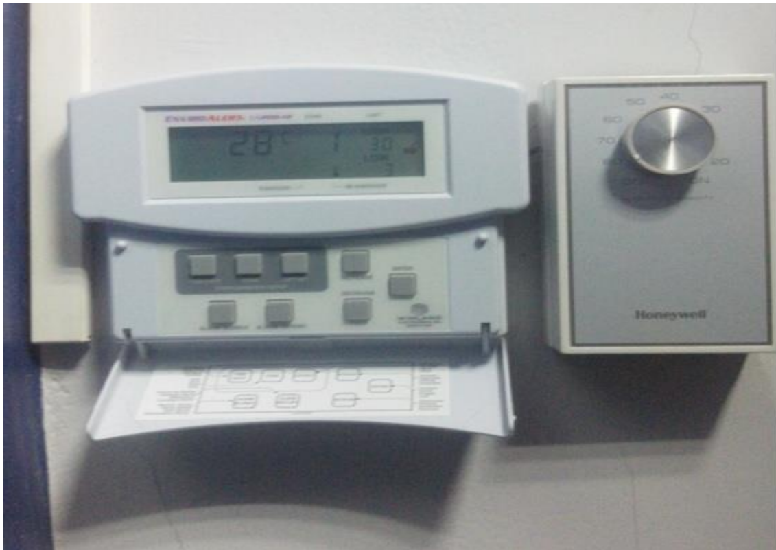
Figura N°9.6 Sensores de temperatura y humedad Fuente : fotografía tomada por el autor
