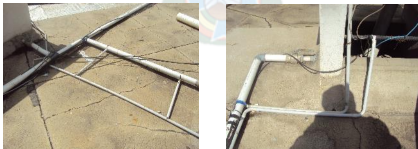
Figura 3.20 Cables puestos en ductos correctamente
