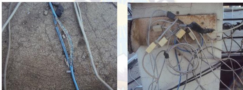
Figura 3.19 Cables pelados sin protección y enredados
