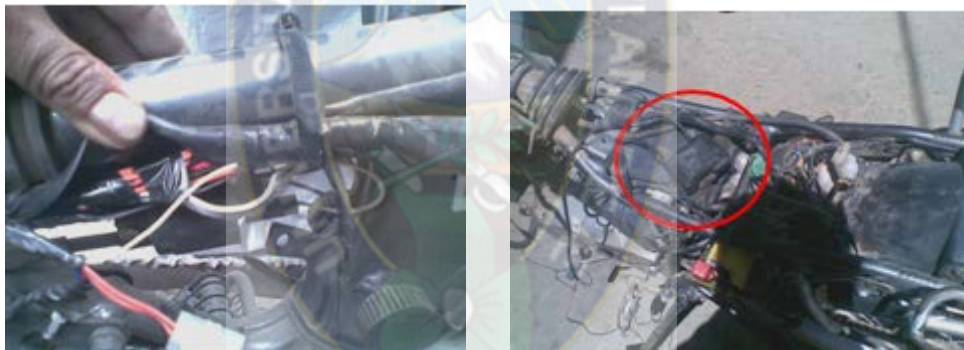
Fig. 47 Localizando cables sistema de encendido, Lugar: El Alto, garaje Zona Norte 16 de Julio, Registro: Motocicleta Suzuki 200, Fecha de la fotografía: 16 de octubre de 2014
