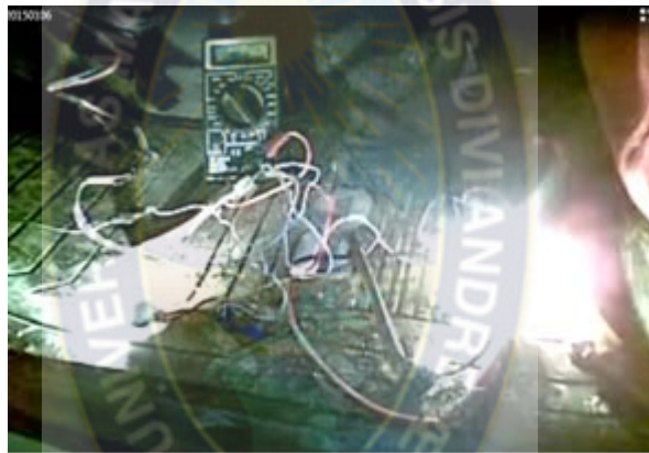
Fig. 62 Pruebas electricas en cables GPS, fusibles nuevos instalados, Lugar: El Alto, planta Av. Juan Pablo II, Ex tranca, C. Martin Lutero, Registro: Camión Nissan Cóndor, Fecha de la fotografía: 6 o de Enero de 2015
