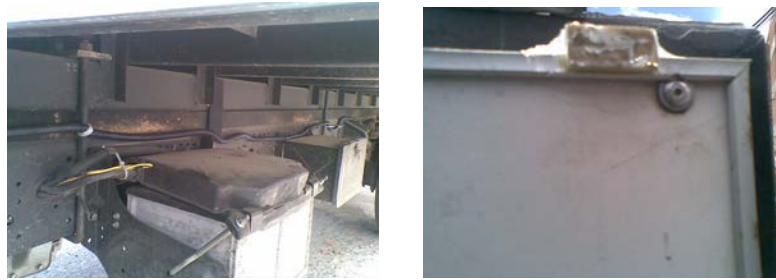
Fig. 52 Cableducteado hacia el interruptor de apertura de puerta, Lugar: La Paz, vivienda Z. Achumani entre Calle 22 y Gral. Inofuentes, Registro: Camión JAC HFC1048K, 2013, Fecha de la fotografía: 29 de noviembre de 2014
