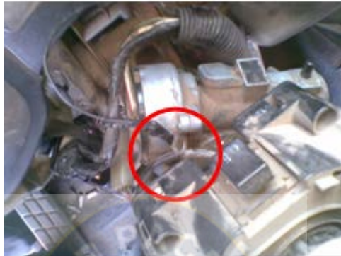
Fig. 54 Cable negativo del GPS desconectado, Lugar: El Alto, parqueo Av. 6 de Marzo frente Zona Franca Comercial, Camión Nissan FUSO, Fecha de la fotografía: 2 de junio de 2014
