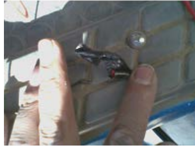
Fig. 58 Cable GPS desconectado, Lugar: El Alto, parqueo Av. 6 de Marzo frente Zona Franca Comercial, Camión Nissan FUSO, Fecha de la fotografía: 30 de julio de 2014
