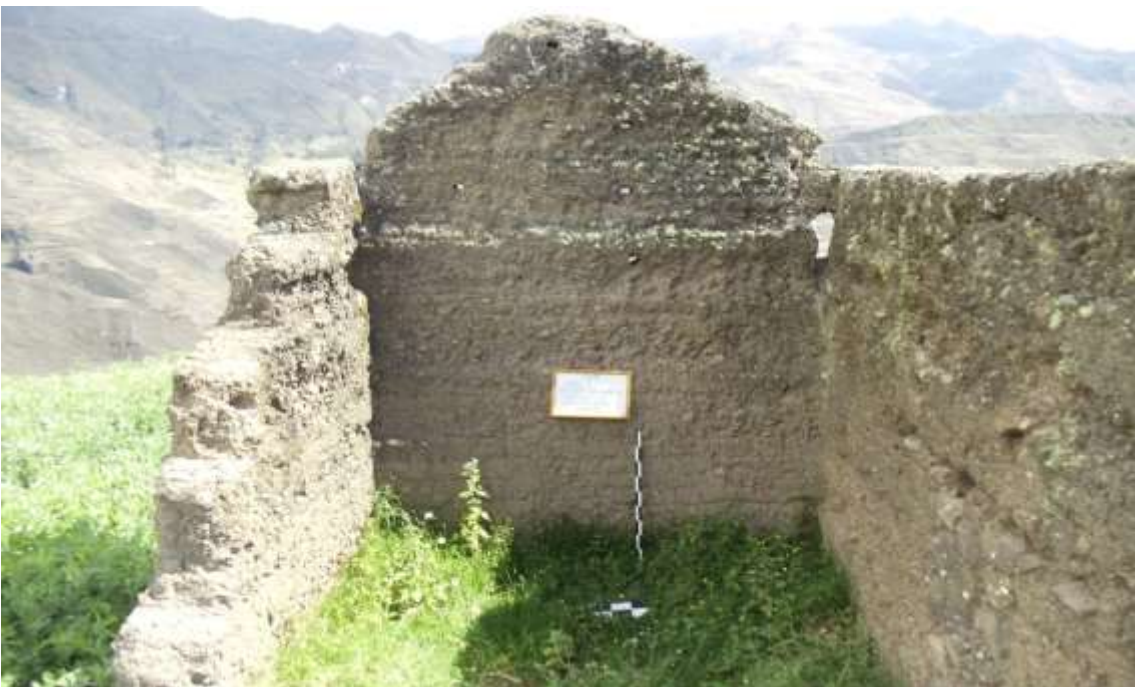
Figura 25: Estructura 3 se observa los agentes destructivos
