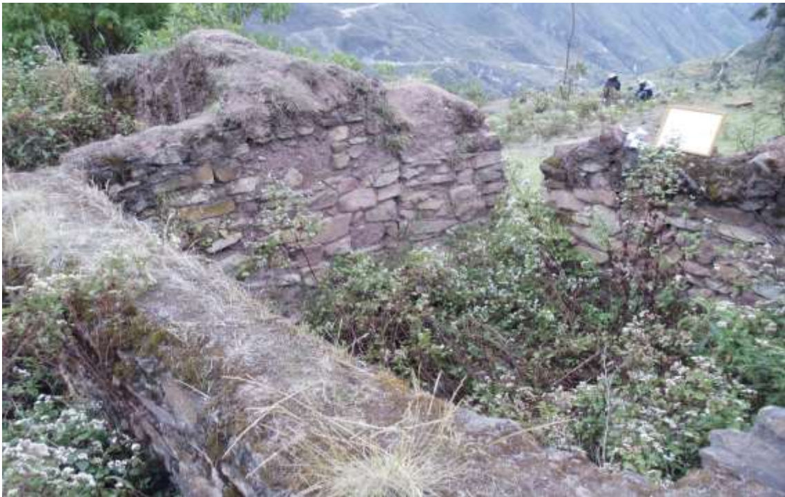
Figura 30: vista de la alta densidad de vegetación dentro la estructura
