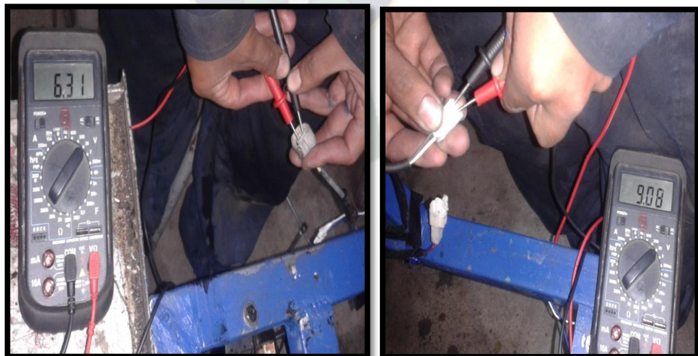
Figura 42. Medición del voltaje de los sensores de velocidad.
