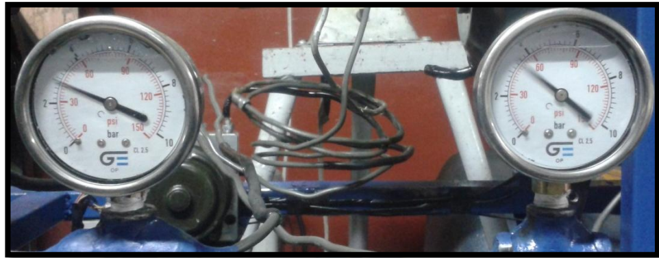
Figura 33. Ubicación de los manómetros.
