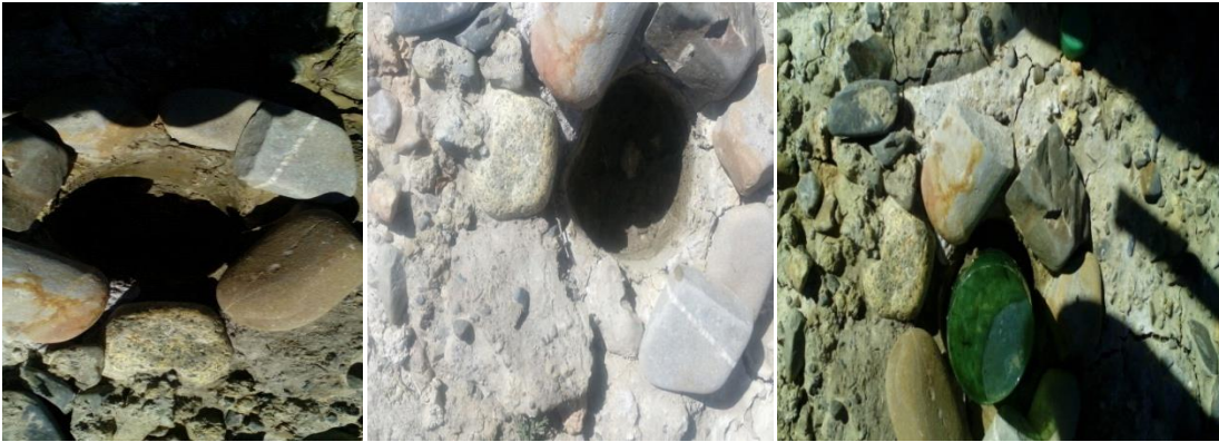
Ilustración 28: humedad presente luego de una semana en las pruebas previas(fuente propia)
