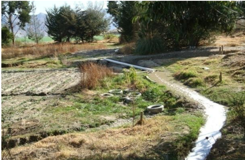
Fotografía N° 2. Vista de la infraestructura de riego del Centro Experimental, en desgaste
