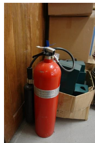
Figura 43 Extintor de fuego. Foto V. Oros
