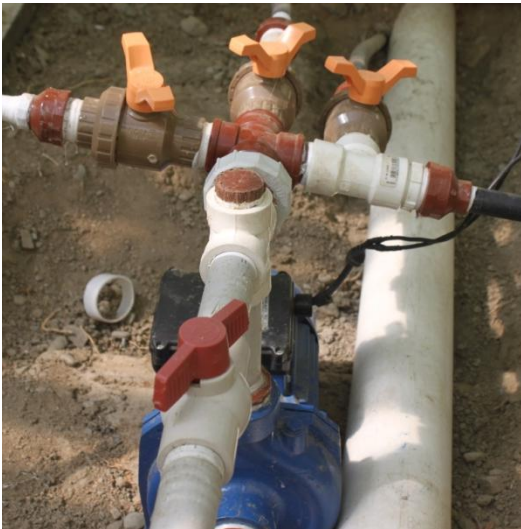
Sistema de Bombeo
