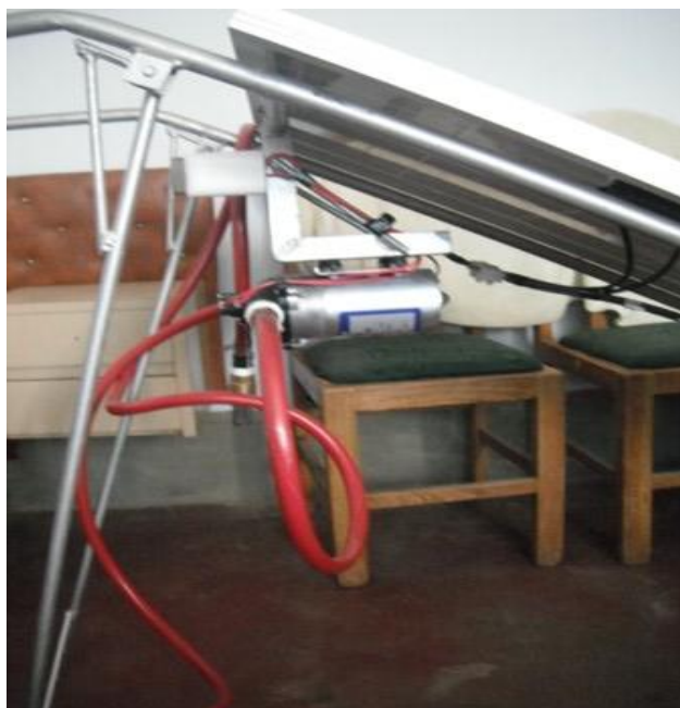
Figura 8. Sistema de bombeo fotovoltaico
