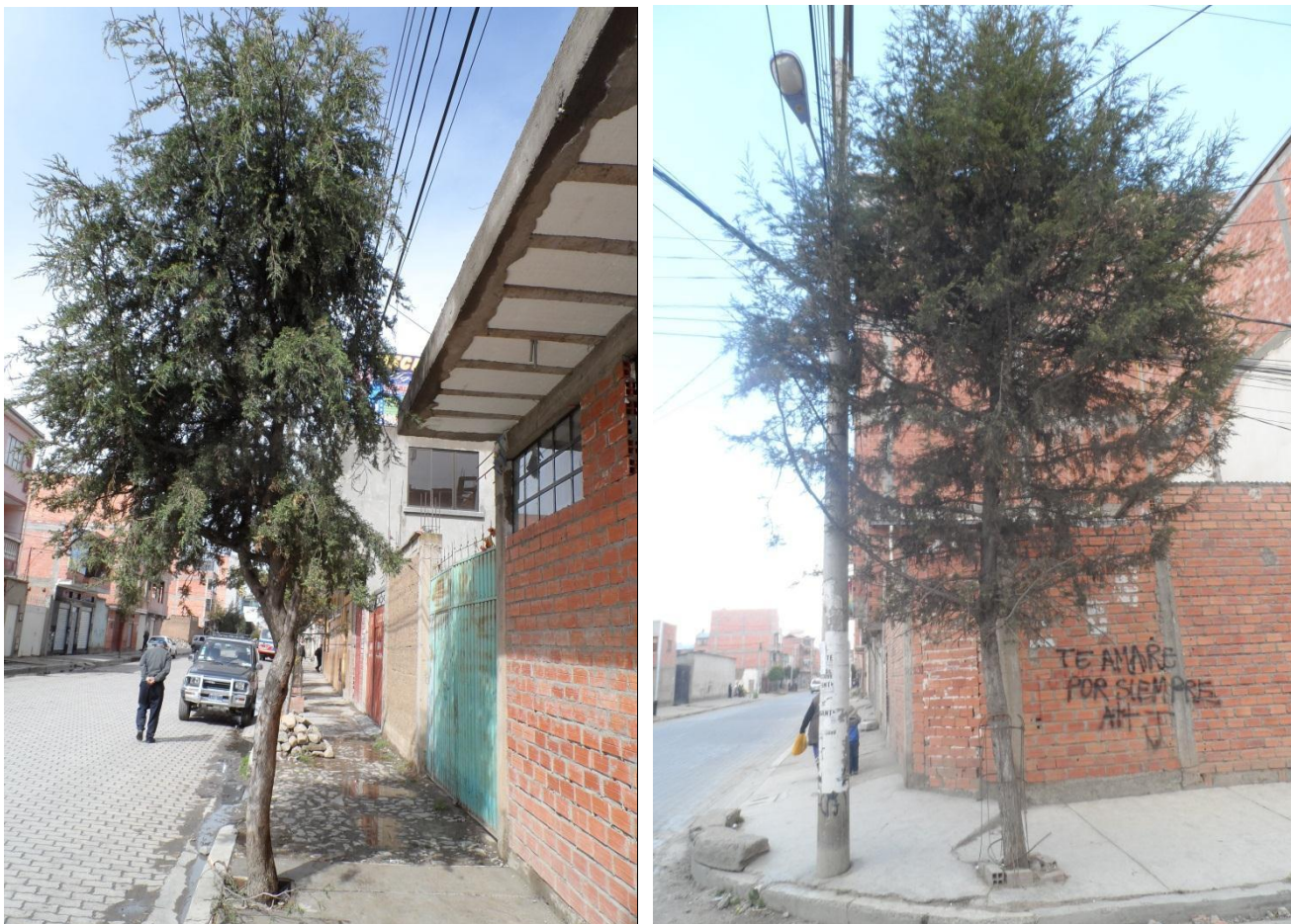
Figura 6. Árbol crecido y enredado con los cables de luz y teléfono
