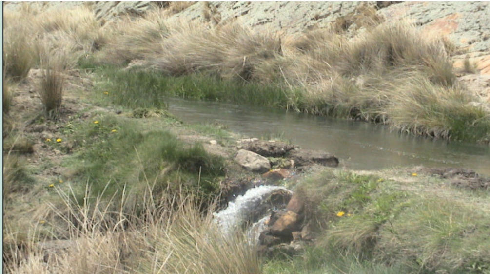
Toma de agua de canal principal a canal secundario (sistema de riego No52 – Comunidad Pongon Huyo)
