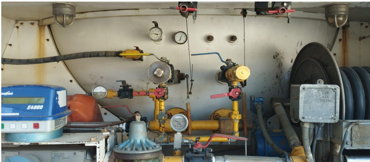
Figura 5.12. Panel de Control de Distribución de GLP a granel de la UGLP
