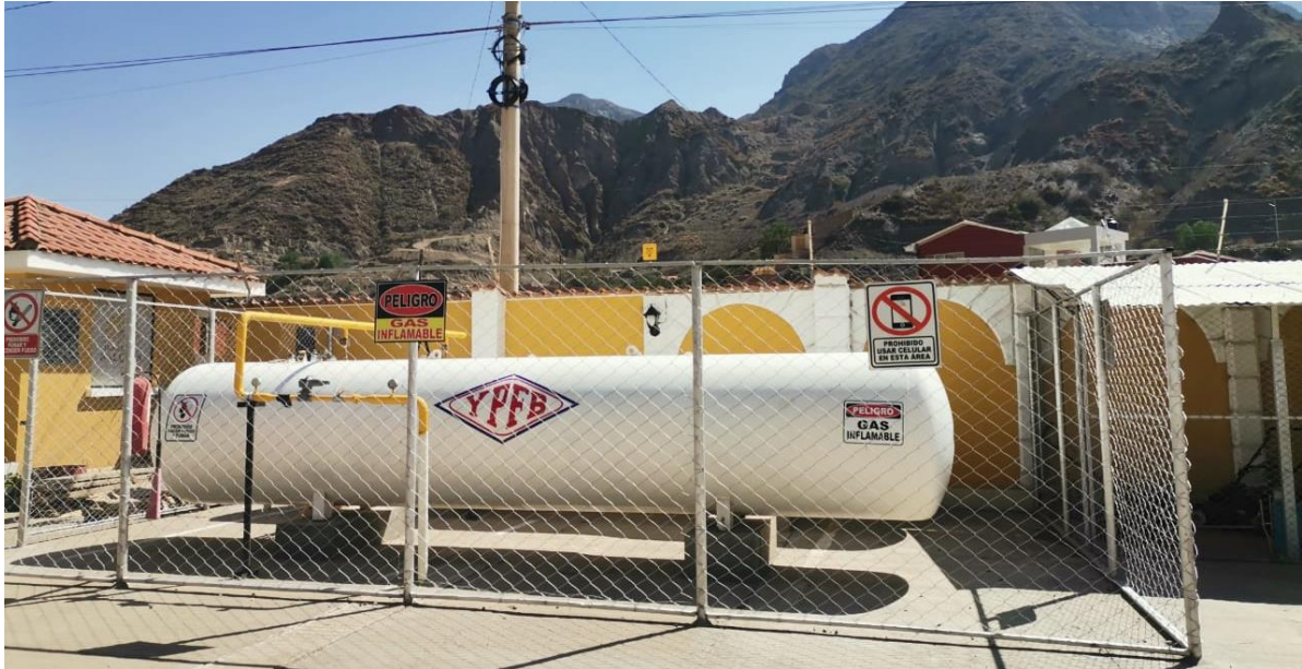
Figura 3.3. Tanque instalado de 7 m 3 en HOTEL SALQUIS CLIENTE DE YPFB
