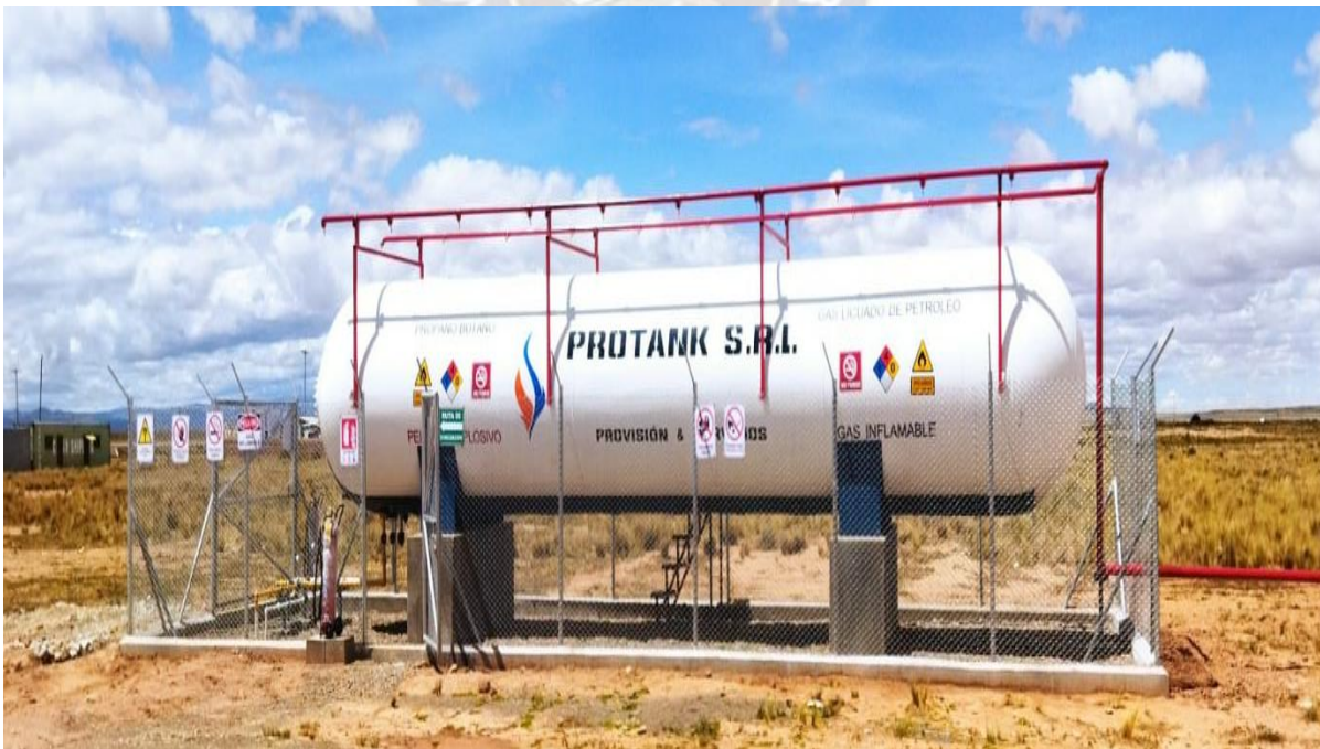
Figura 2.11 Tanque de Almacenamiento de 48 m 3 de Cliente Industrial
