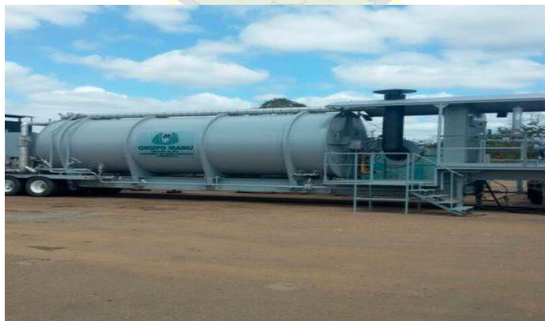
Figura 2. 21: Equipos de inyección de vapor
