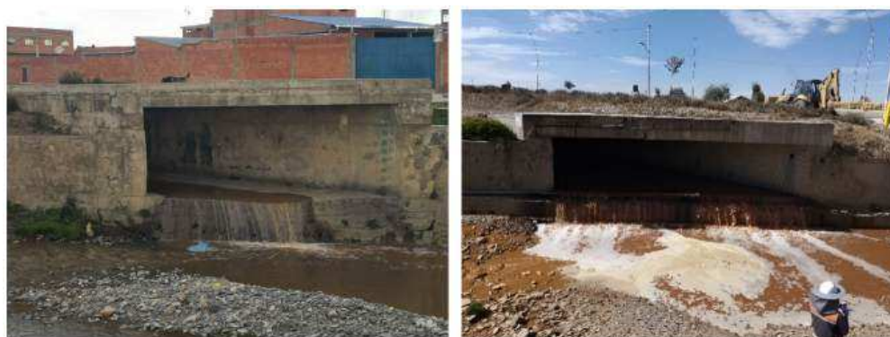
Fotografía 4. Descarga de aguas pluviales
