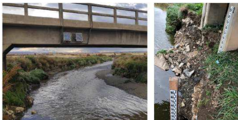
Fotografía 10. Estación hidrométrica y regla limnimétrica
