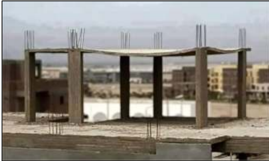
Figura No. 20 Losa con deflexión excesiva.
