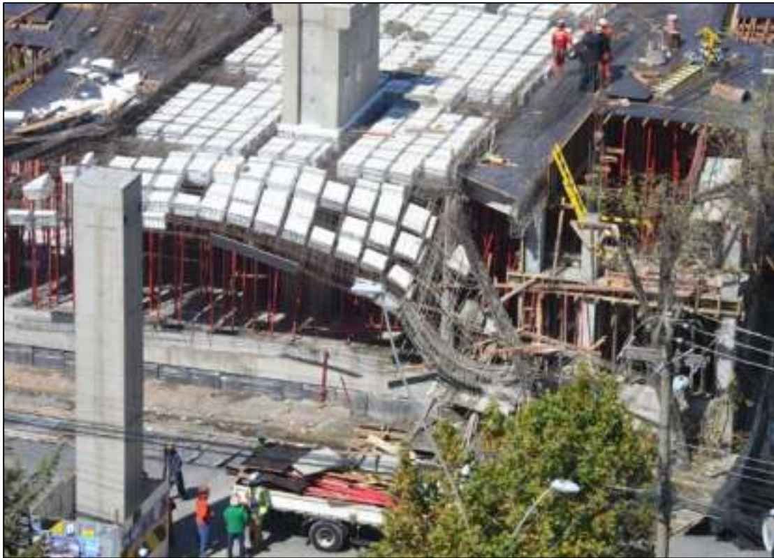
Figura No. 3 Falla en el encofrado por el desplome de la plataforma en la estación del teleférico de la Línea Blanca (La Paz – Bolivia, 07-05-2016).
