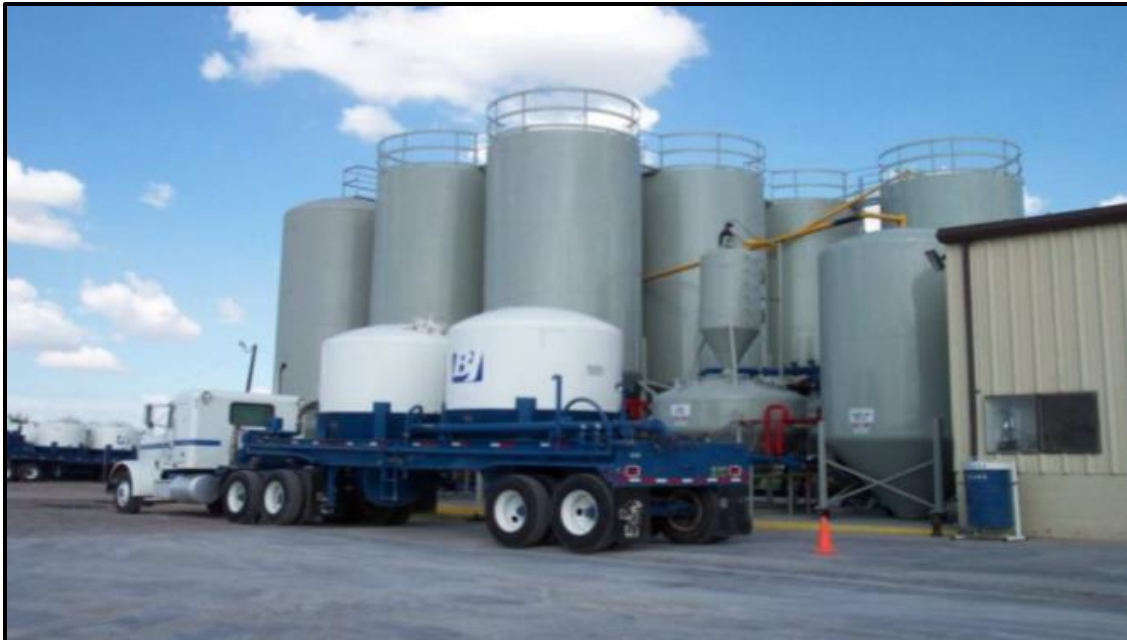
Figura 2.37. Almacenamiento de Cemento Seco
