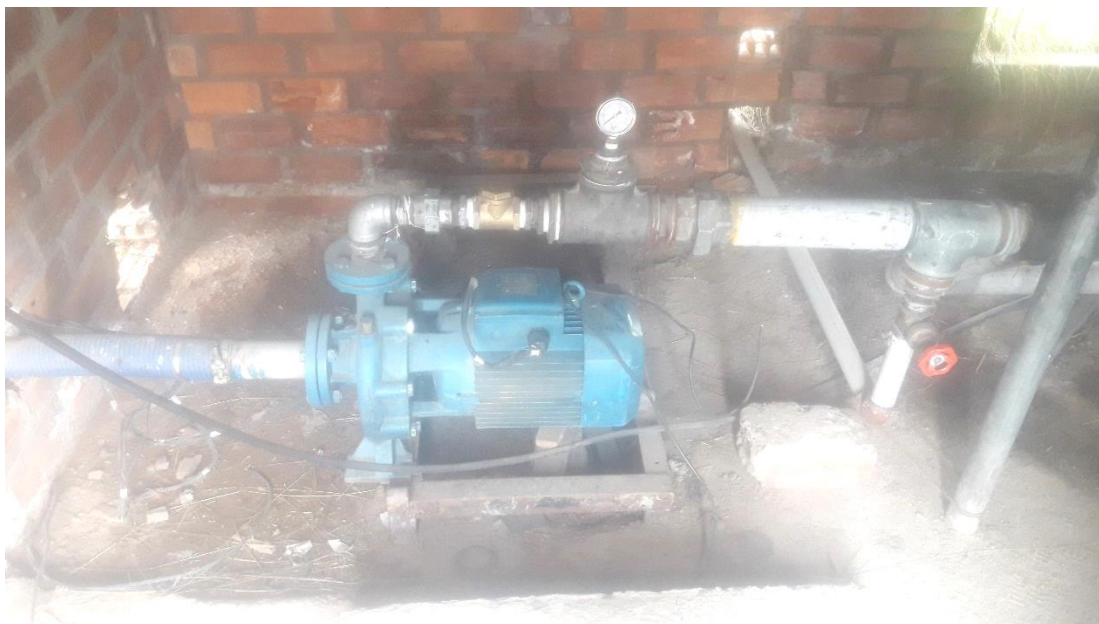
Figura 9. Unidad de bombeo
