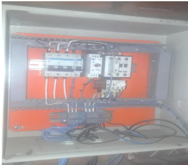
Figura 6. Sistema de control de la maquina
