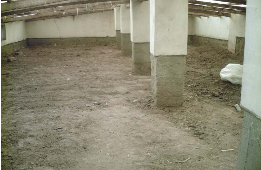
Figura 2. Estado de la carpa previo al acondicionamiento
