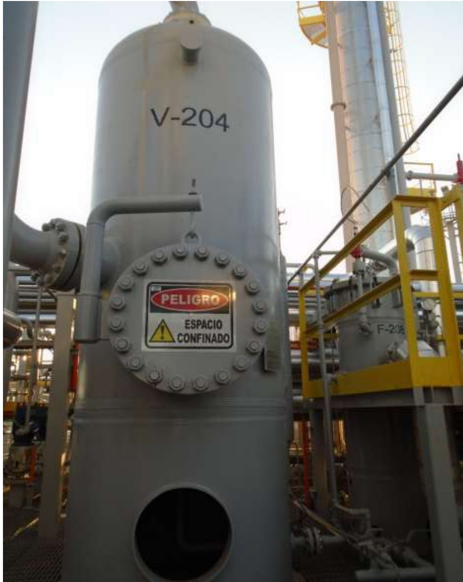
V-204, Scrubber de gas dulce, recipiente vertical de 48ft de diámetro y 8ft de longitud (YPFB Chaco).
