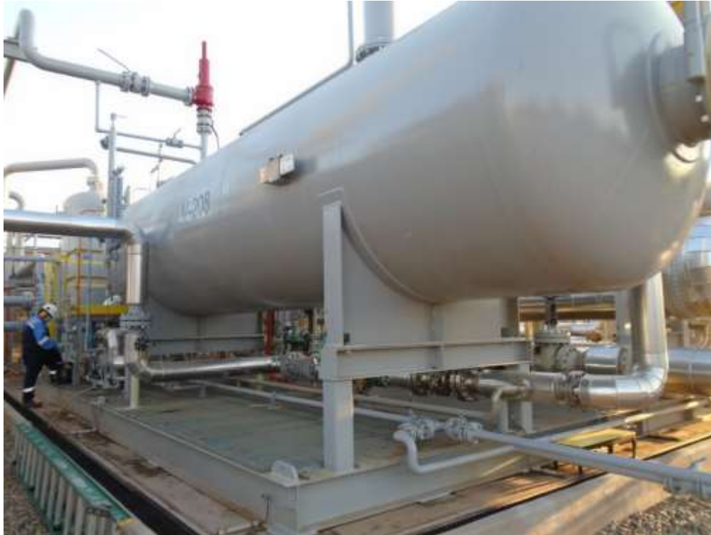
V-208, separador flash de amina, separador horizontal de 78'' de diámetro y 24ft de longitud (YPFB Chaco).
