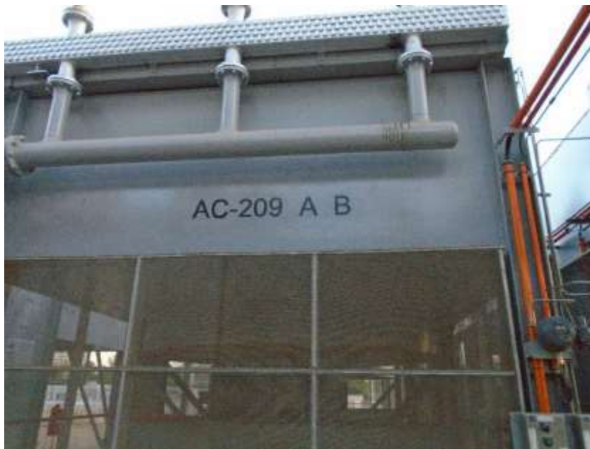
AC-209 A/B, Aeroenfriador de amina pobre (YPFB Chaco).
