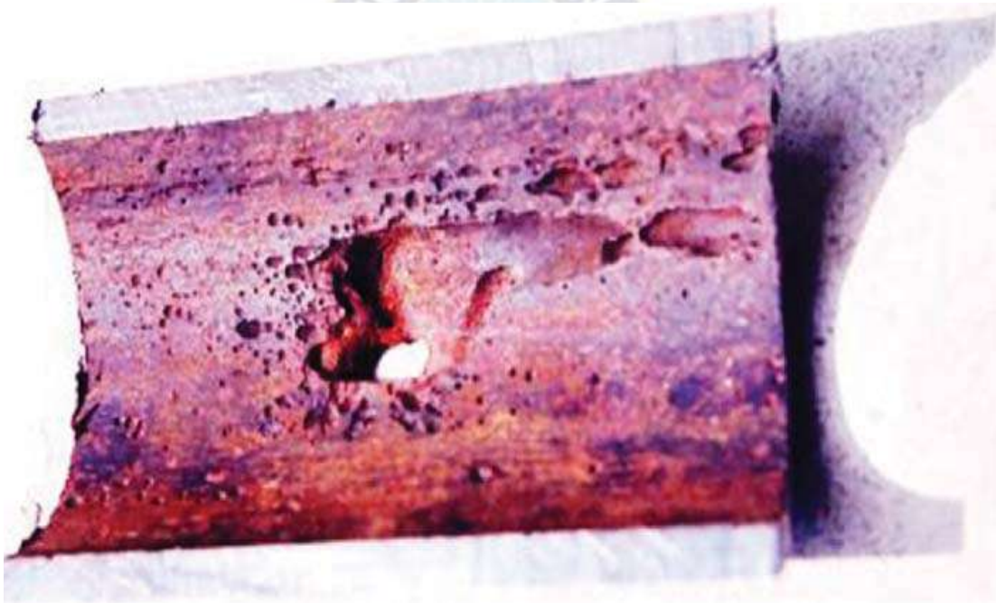
FIGURA 2.7: CORROSION INTERNA POR PICADURAS
