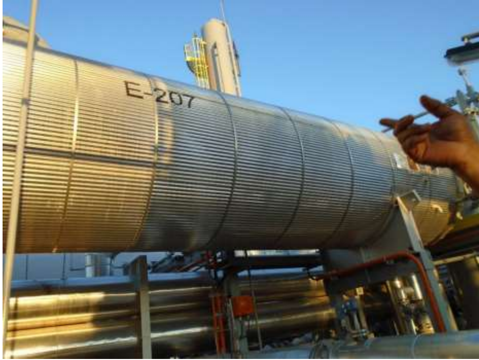
E-207, Reboiler de torre regeneradora de amina, intercambiador tipo horizontal de tubo y coraza, con 295 tubos de 0,75'' de diámetro, con una longitud de 15,25ft (YPFB Chaco).
