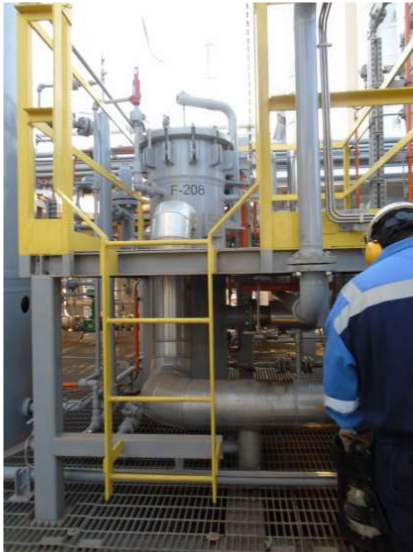
F-208, filtro de partículas de amina rica, filtro mecánico vertical de 24'' de diámetro que remueve partículas sólidas mayores a 5 micrones (YPFB Chaco).
