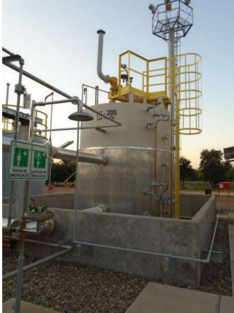
TK-205, Tanque de almacenaje de amina, es un tanque API de acero al carbono de 120 in de diámetro y 11 ft de altura (YPFB Chaco).
