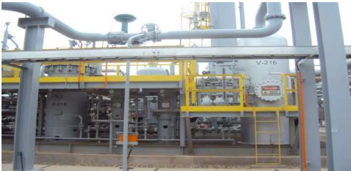
F-214, filtro de carbón activado de amina pobre, F-212 A y F-212 B post-filtro de partículas de amina pobre, V-216 acumulador de reflujo de la regeneradora de amina (YPFB Chaco).
