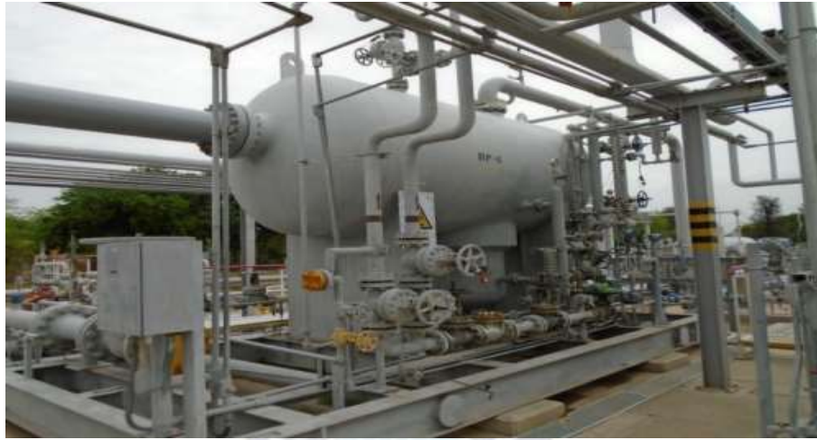
FIGURA 4.3: SEPARADOR HP-6 DE LA PLANTA LVT
