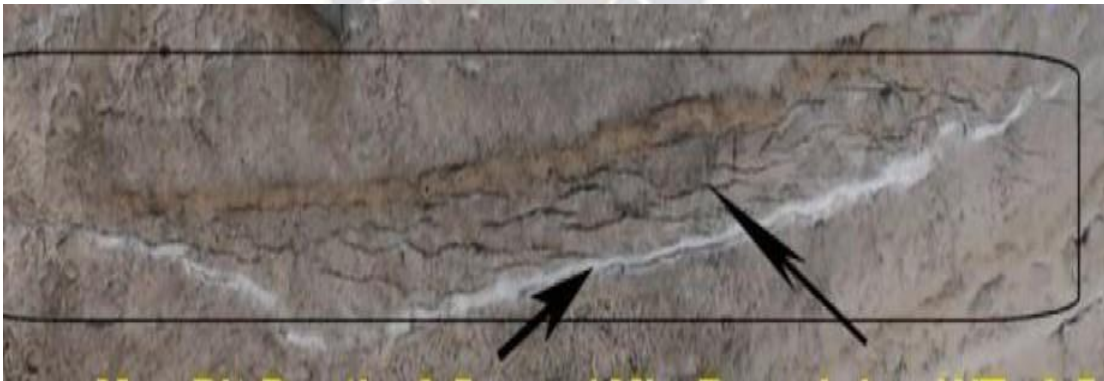
Figura 1. 1 Grieta significativa de tubería. Tomada de API 579
