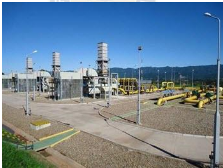
Figura 9: Estación de Compresión Campo Grande
