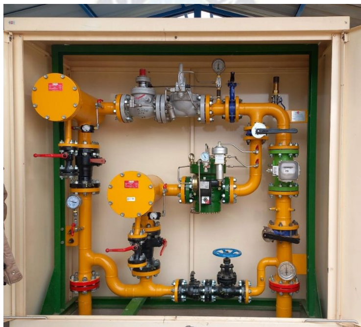
Figura 23: Estación Distrital de Regulación
