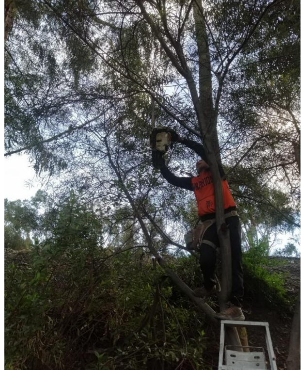
Foto 5. Cortado de ramas que perjudican los cables
