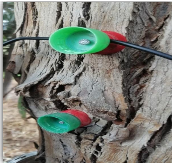
Figura 27. Árbol de eucalipto utilizado como poste para la extensión de cables
