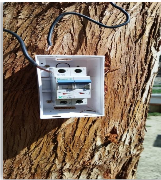
Figura 25. Térmico con caja de protección
