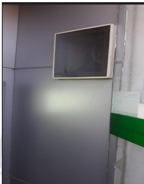
Figura 51: Foto ATM con Cámara IP empotrada en la pared con protección de vidrio polarizado
