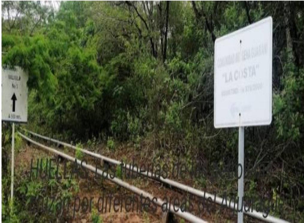
Tuberías de petróleo por la Serranía del Aguaragüe
