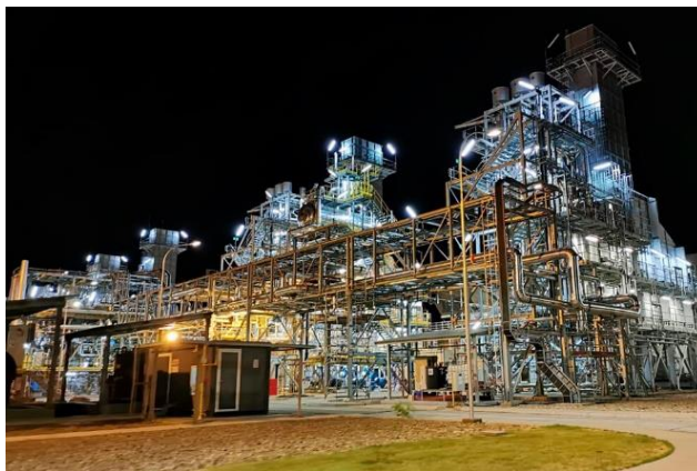
Figura 2.4. Termoeléctrica de Entre Ríos.
