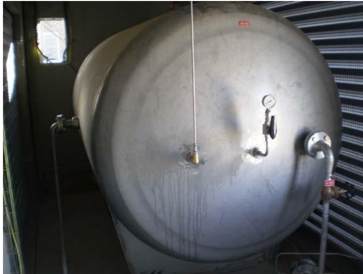
Figura 9 Depósito de almacenamiento boil-off
