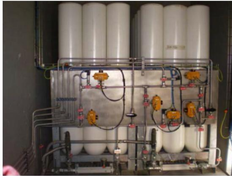
Figura 8 Racks de Botellas de Almacenamiento GNC
