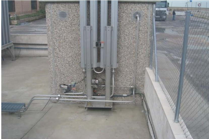
Figura 12 Vaporizador de depósito boil off
