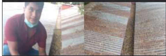
INSPECCION DE TECHOS DE HOSPITAL SAN BORJA, POR LAS GOTERAS INTERIORES QUE SE PRESENTARON
