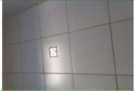
Foto N° 22 Rejillas de piso.
