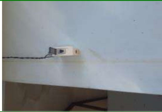
Foto N° 8 Disyuntor par la bomba de agua.
