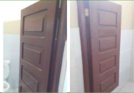
Foto N° 16 y 17 Puertas Cambiadas.
