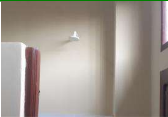
Foto N° 25 Ducha simple colocada.
