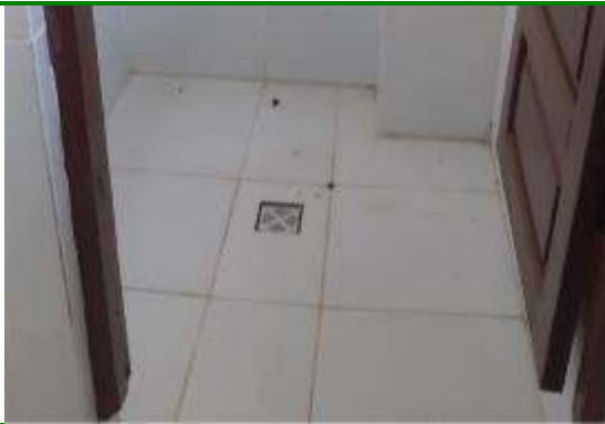
Foto N° 23 Rejilla de piso de duchas.
