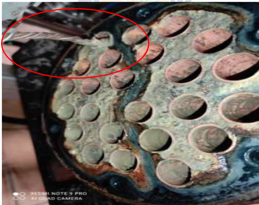
Anexo 2. Limpieza inadecuada de condensador
