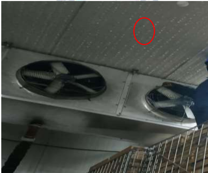
Anexo 6, Acumulación de cristales de agua en techo de cámara
