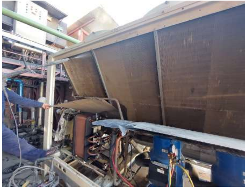
Anexo 5. Limpieza de condensador enfriado por aire
