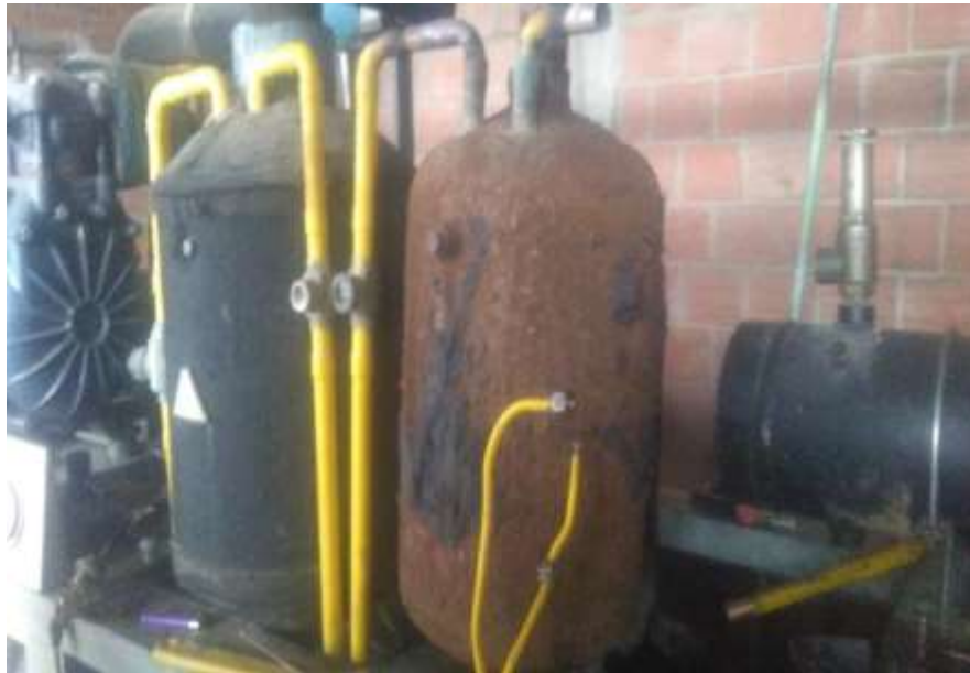
Fotografía 6. Tanque subenfriador Fuente. Elaboración propia
