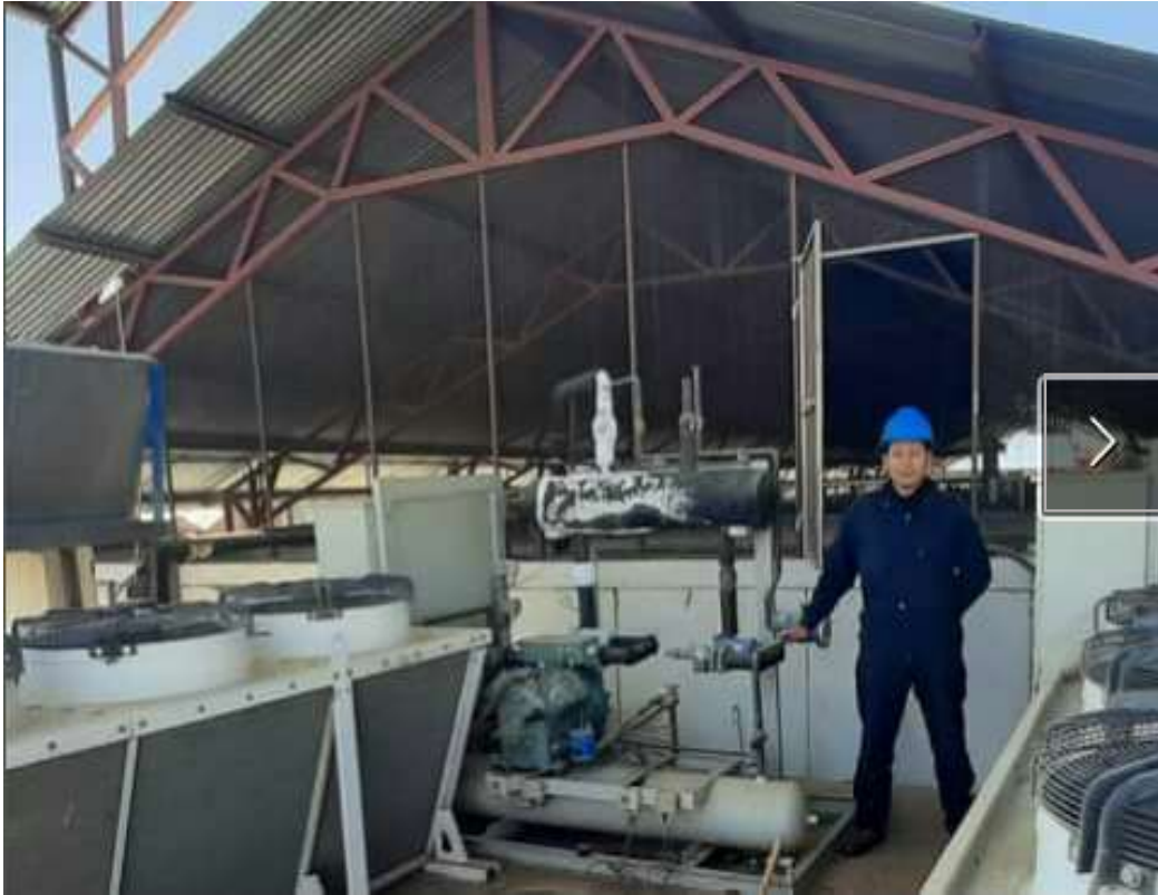
Anexo 11. Sala de máquinas cámaras de refrigeración, planta de producción
