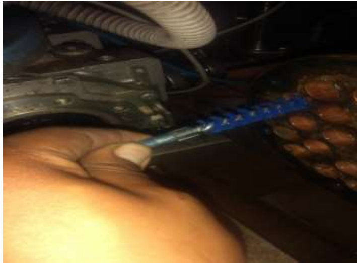
Fotografía 7. Limpieza de condensador
