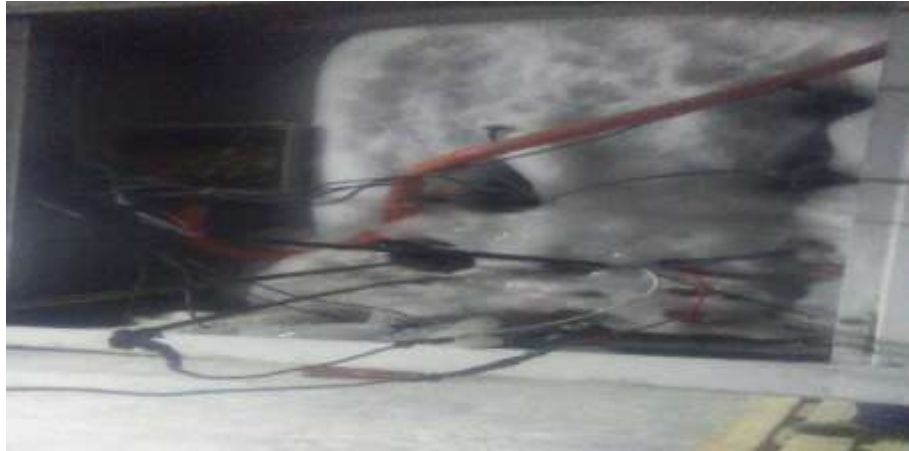
Fotografía 14. Falla en resistencias de deshielo del evaporador Fuente. Elaboración propia
