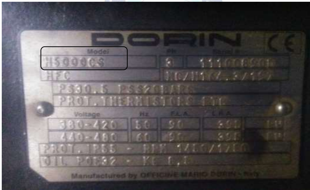
Fotografía 4. Placa de características de compresor
