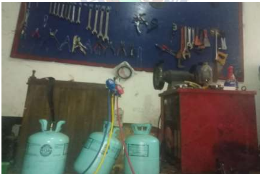
Anexo 10. Gabinete de herramientas taller de refrigeración
