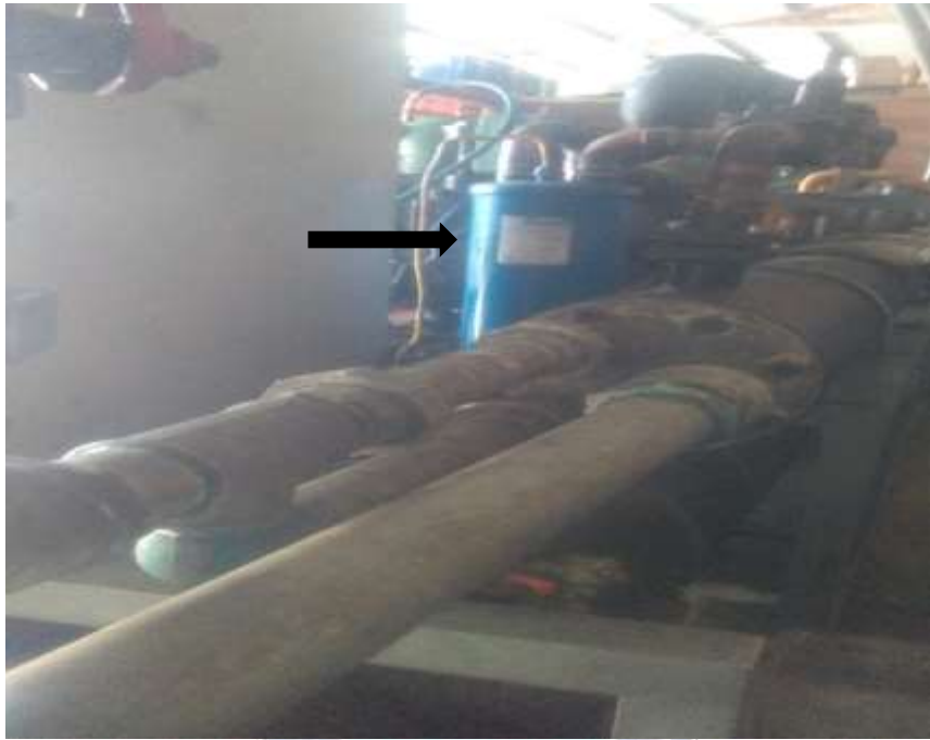
Anexo 3. Tanque separador de aceite en paleta
