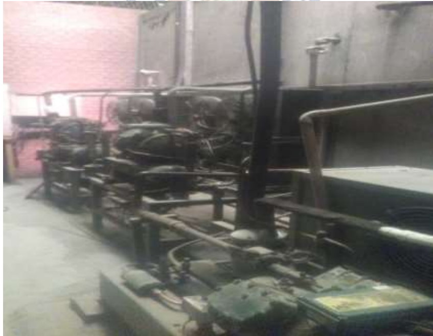
Anexo 8. Sala de máquinas cámaras de refrigeración, almacén
