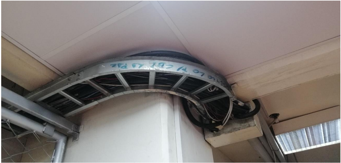
Ducto por donde pasa el Backbone
