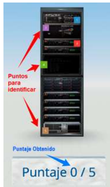
Figura 11. Material en Realidad Aumentada, práctica sobre rack de servidores.
