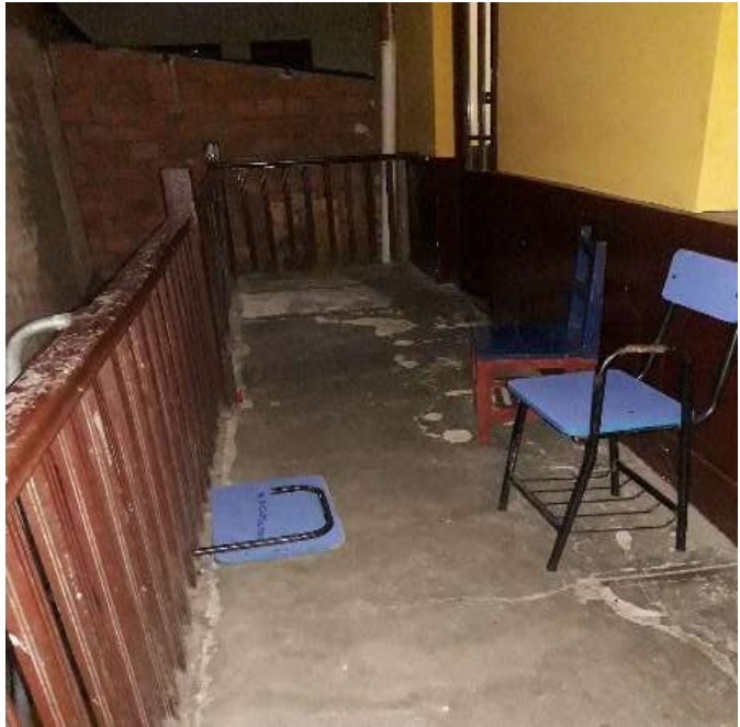
Fig19. Pasillo de la escuela. Se muestra malas condiciones, mobiliario fuera de lugar necesita reparación. Fuente propia
