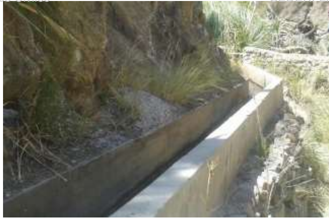
Figura 13. Zona de riesgo de deslizamiento.
