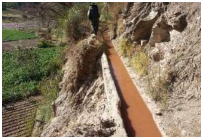
Figura 12. Zona de deslizamiento.
