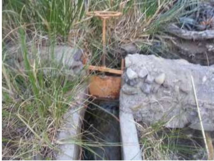
Figura 9. Ubicación de compuertas de distribución.
