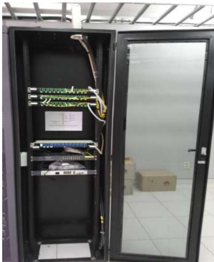
Figura 4.5.4 Cuarto de Comunicaciones
