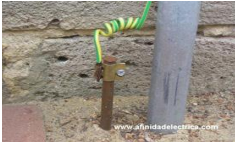
Fig48. Conexión de puesta a tierra a la estructura.
