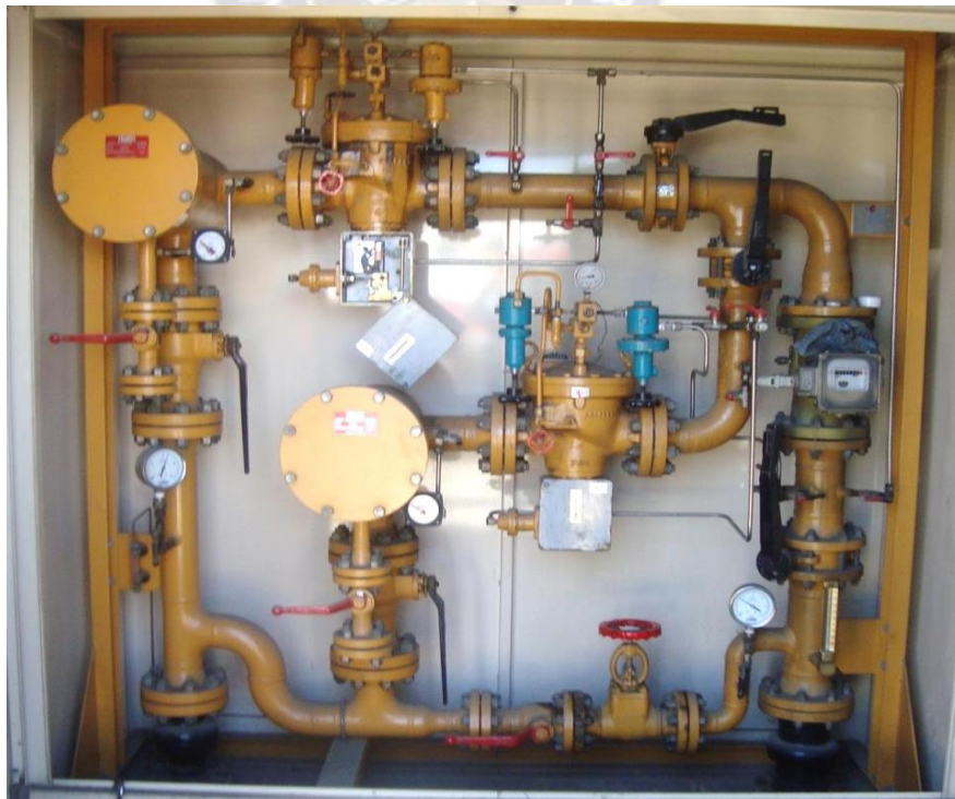
Figura 3.13. Vista frontal del EDR - 3
