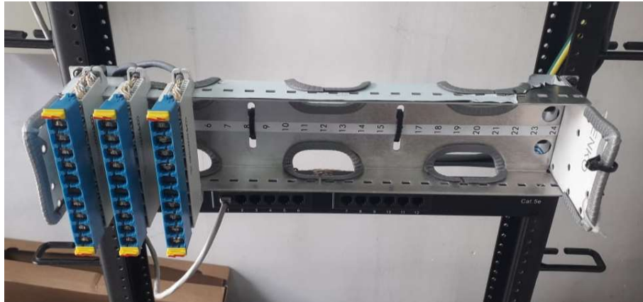
Figura 2-10: Pach Panel y regleta de protección para cable Ethernet
