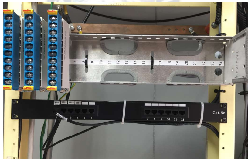
Figura 2-24: Pach panel de transmisión y protectores de línea para los cables Ethernet de la WBS
