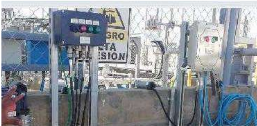
FIGURA 4.5 PANEL DE CONTROL DE PASO
