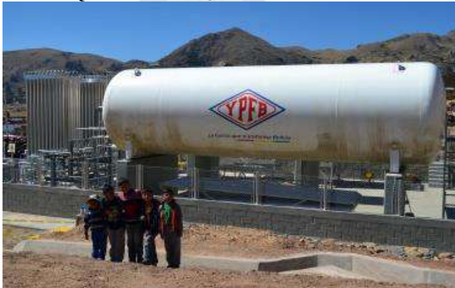
FIGURA 3.5 TANQUE DE ALMACENAJE EN UNA ESTACIÓN DE REGASIFICACIÓN
