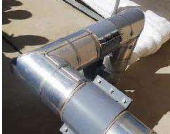
FIGURA 4.8 TUBERÍAS PARA EL PASO DE GNL - B
