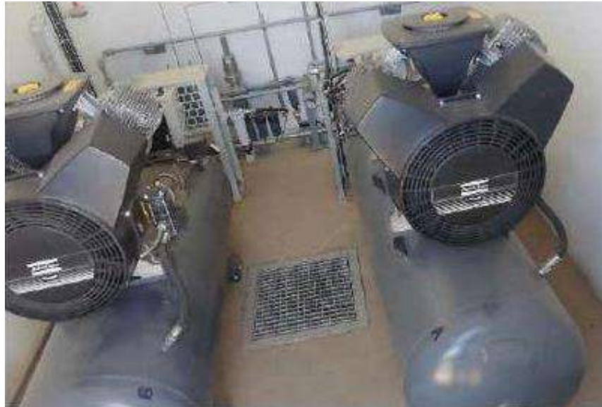
FIGURA 4.19 SALA DE COMPRESORES
