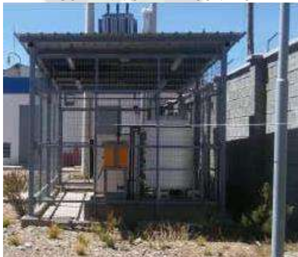
FIGURA 4.20 SALA DE CONTROL
