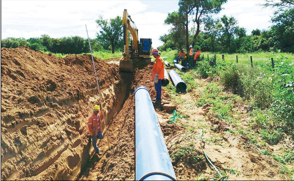
Figura 3: Tuberías En Línea De Conducción Por Gravedad. Fuente: https://sswm.info/es
