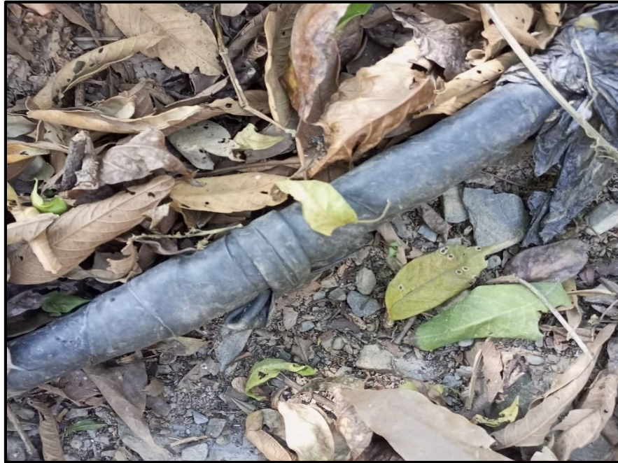
Figura A 5: Tuberías En Mal Estado Fuente: Elaboración Propia
