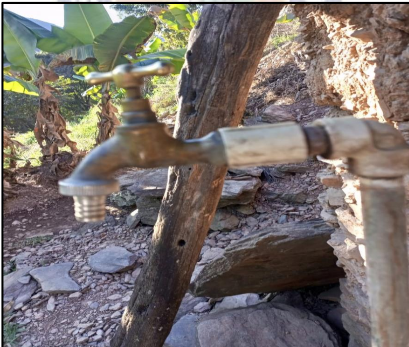
Figura A 6: Piletas Sin Suministro De Agua Fuente: Elaboración Propia
