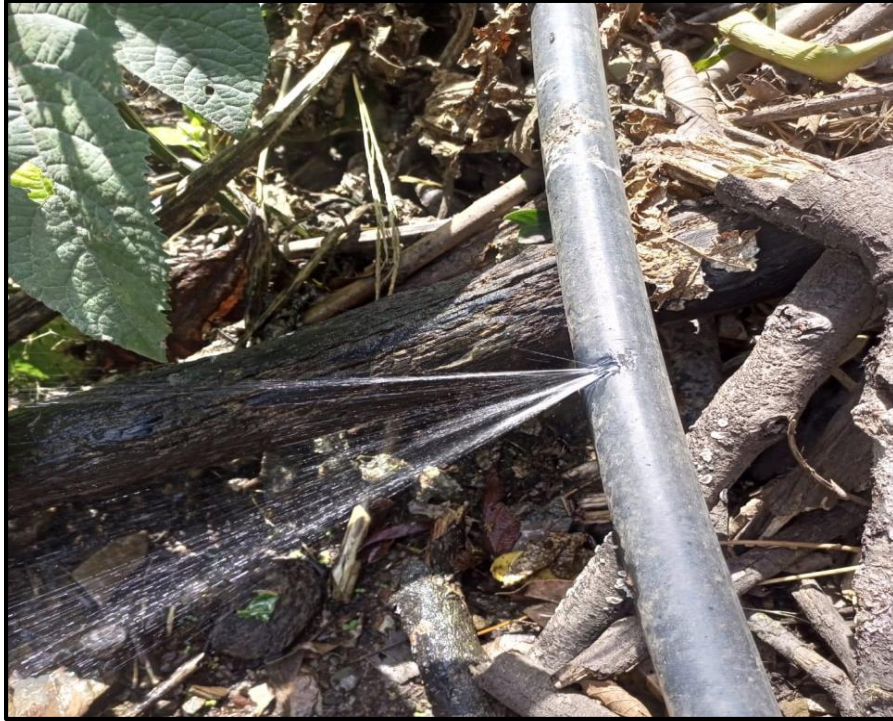
Figura A 3: Tuberías Afectadas Por Animales De La Región Fuente: Elaboración Propia
