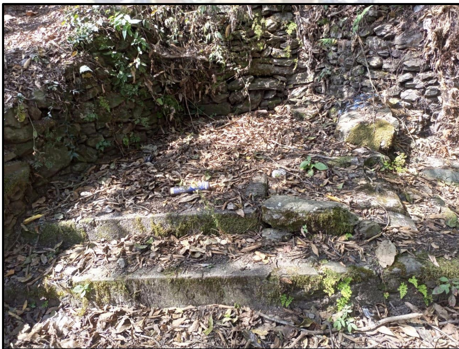
Figura A 4: Tanque De Almacenamiento Deterioradas Fuente: Elaboración Propia
